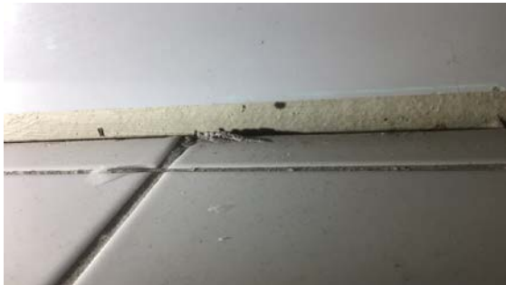
Mangler oppkant flis
