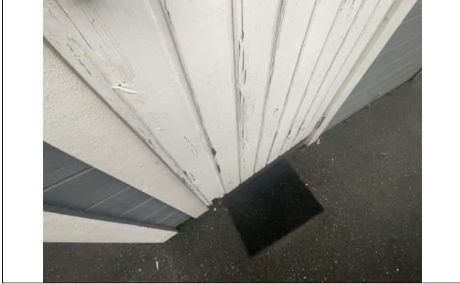
Dør utvendig bod med skader
