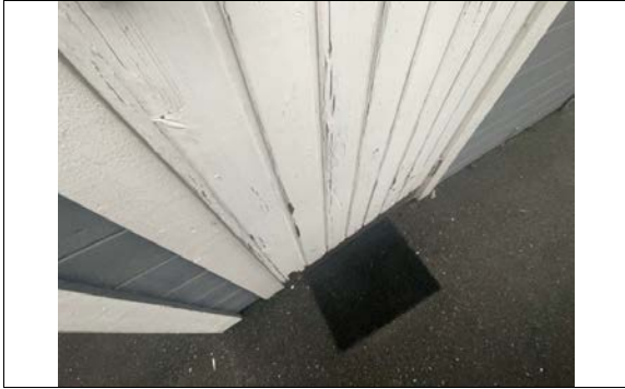
Dør utvendig bod med skader
