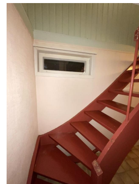
Trapp mangler håndløper på vegg.
