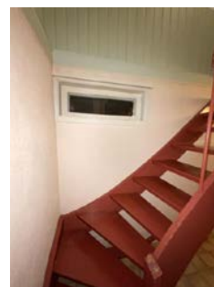
Trapp mangler håndløper på vegg.
