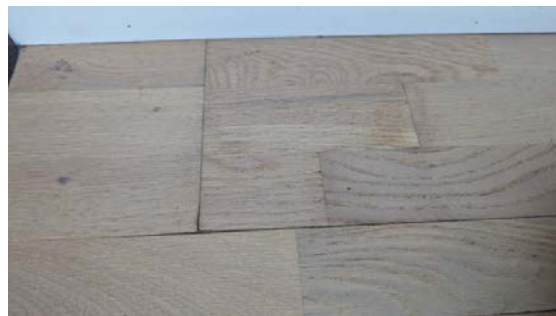
Mindre fuktmerker i parkett etter kondens fra luftfukter
