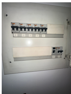
Sikringsskap med automatsikringer.
