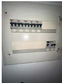
Sikringsskap med automatsikringer.
