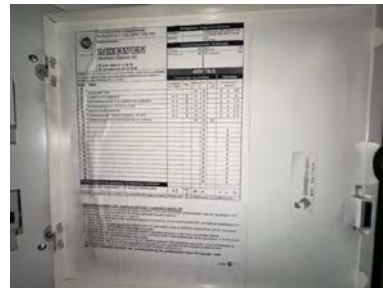
Kursoversikt i sikringsskap
