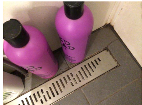
Misfarging fug sprekk flis
