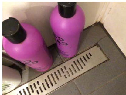
Misfarging fug sprekk flis
