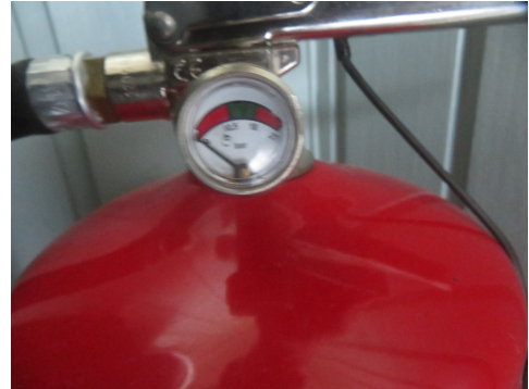
Feil på pulverapparat.
