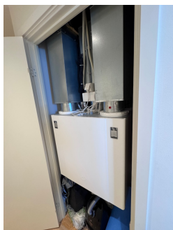
Leilighetens ventilasjonsaggregat er montert i lukket rim i entréen.
