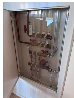
Fordelerskapet og stoppekraner er tilgjengelig i stue/kjøkkenet.
