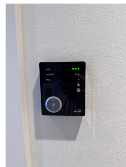
Styringspanel til ventilasjonsanlegget er montert på vegg i entréen utenfor badet.
