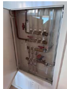
Fordelerskapet og stoppekraner er tilgjengelig i stue/kjøkkenet.
