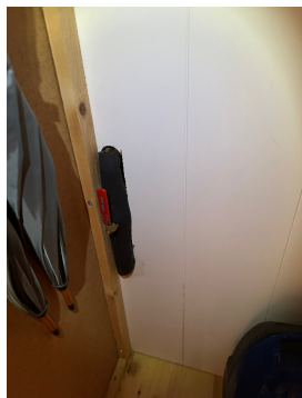
Hovedstoppekran er montert i garderobeskap i kjeller.
