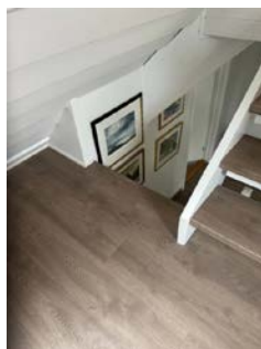
Rekkverk mangler ved siden av trapp i loftsstue.
