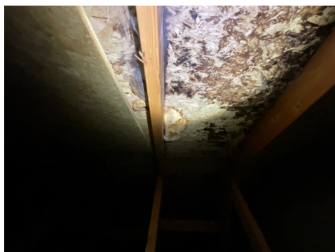
Sopp i undertak og taksperrer
