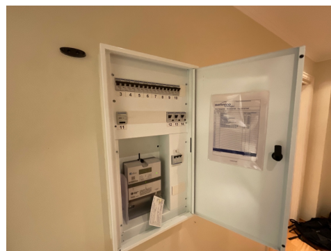
sikringsskap i entreen
