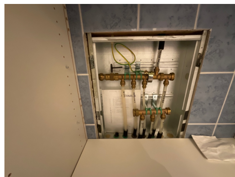
Rør i rørskap på baderom
