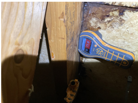
77,8 % fuktighet i taksperrer
