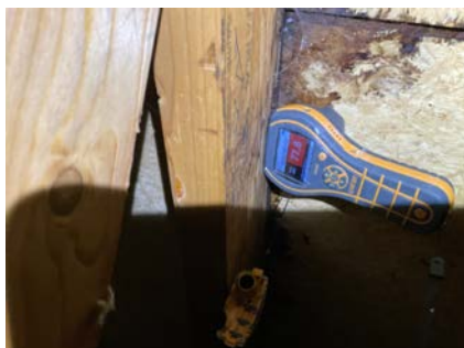
77,8 % fuktighet i taksperrer
