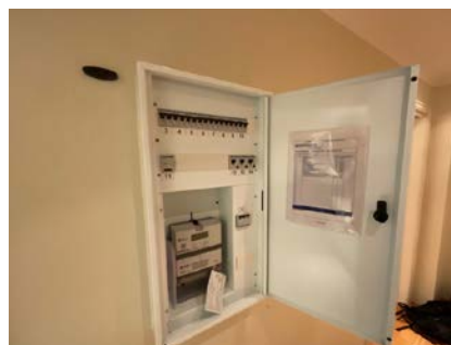
sikringsskap i entreen
