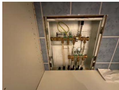
Rør i rørskap på baderom
