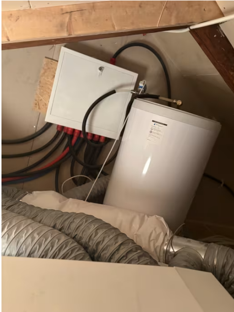
Varmtvannsbereder på hems.
