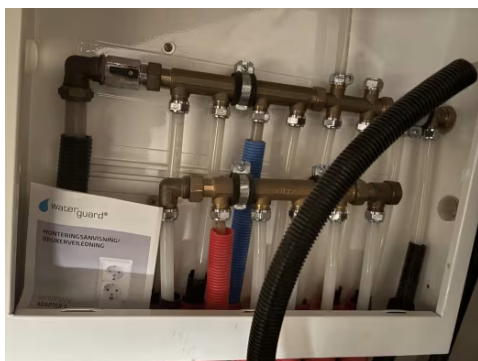
Rørfordelingsskap på hems.
