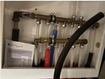
Rørfordelingsskap på hems.
