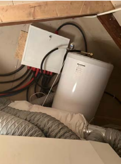
Varmtvannsbereder på hems.
