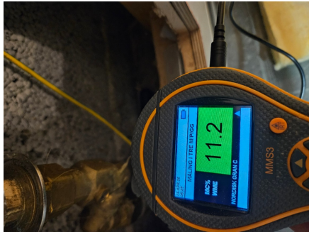
Måling av trefukt i bunnsvill.
