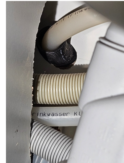
Utett rørgjennomføring i vegg.
