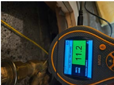
Måling av trefukt i bunnsvill.
