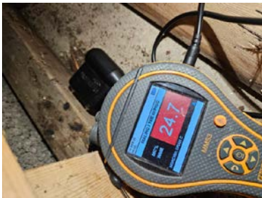
Måling av trefukt i utlektet vegg under bakkenivå.
