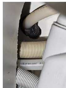
Utett rørgjennomføring i vegg.
