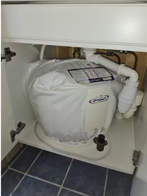
Varmtvannsbereder i annekset.
