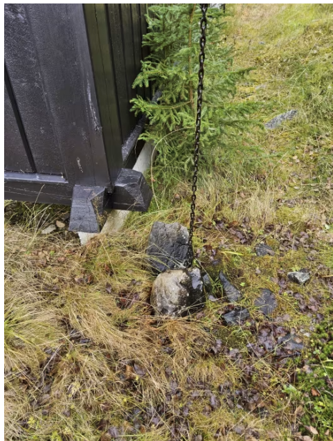
Bildet viser nedløpskjetting.
