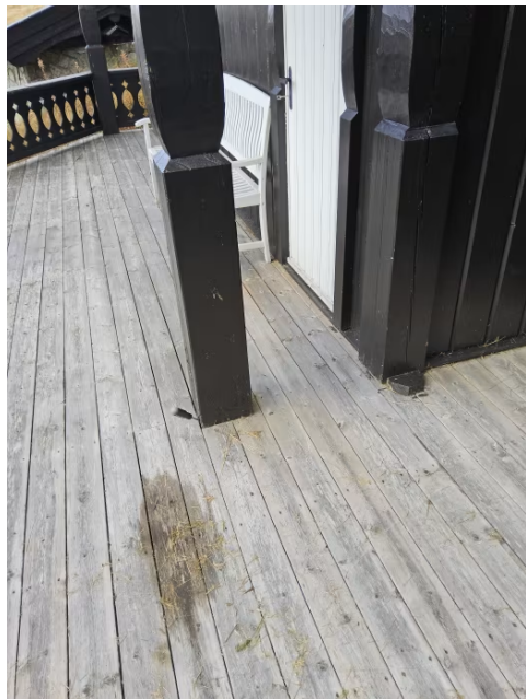
Påbegynt råte i søyle.
