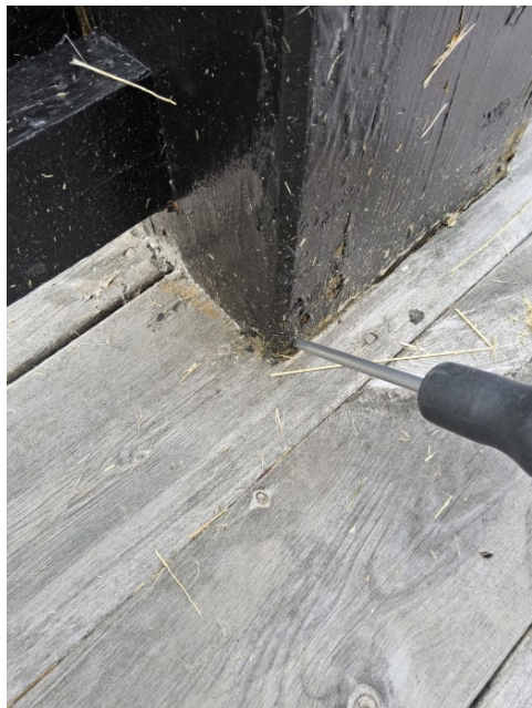
Påbegynt råde i rekkverksstolpe.
