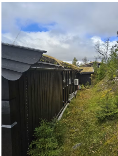
Skjevheter i takrenne på østside. Avstand
