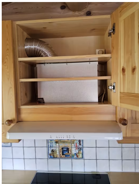
Kjøkkenvifte i overskap.
