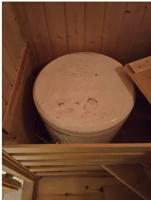
Varmtvannsbereder under benk i badstue.
