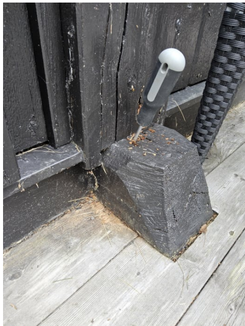
Råte i lafteknute på sørvegg.
