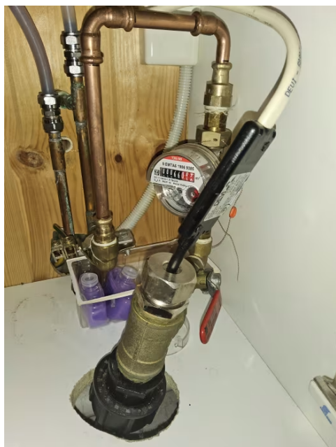
Inntaksledning med varmekabel og
