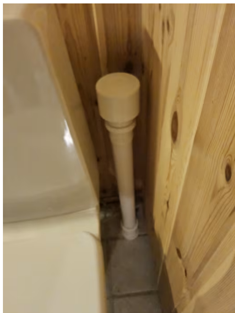
Vakuumventil plassert ved toalett.
