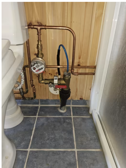
Rørapplegg på bad.
