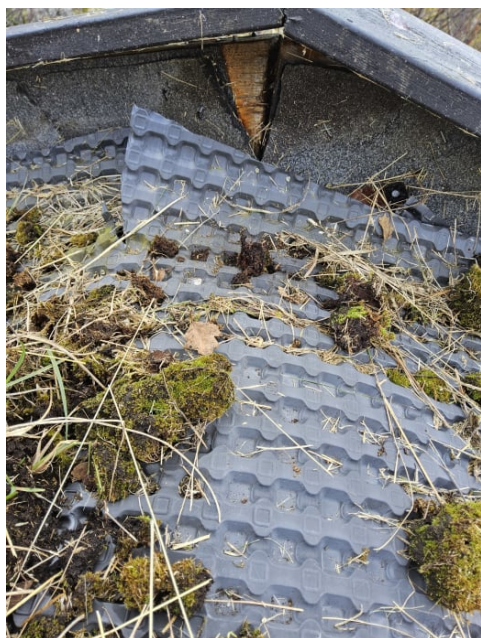
Revne i takpapp på møne.
