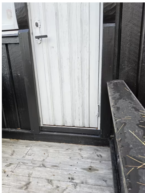
Bilde av værslitt terrassedør fra soverom.
