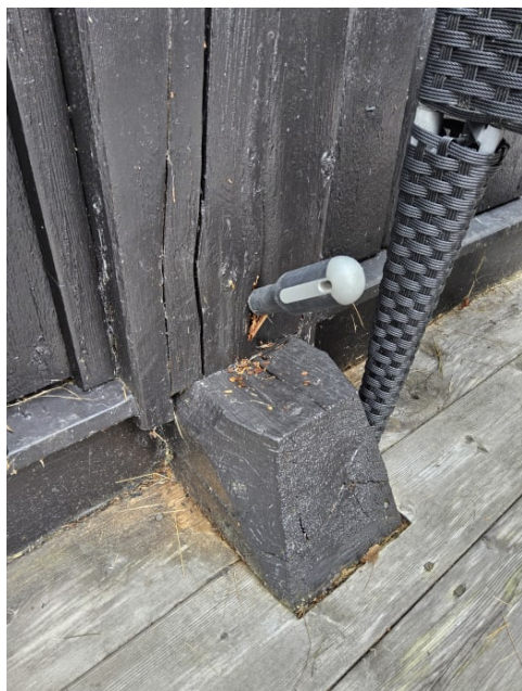
Råte i søyle på sørvegg.
