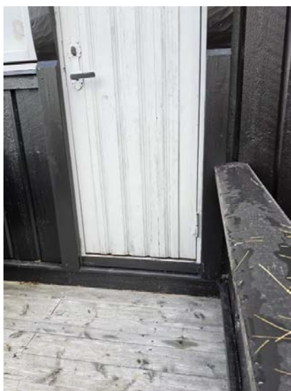
Bilde av værslitt terrassedør fra soverom.
