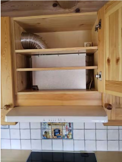
Kjøkkenvifte i overskap.
