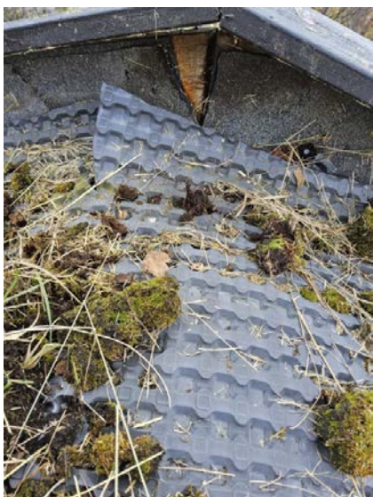
Revne i takpapp på møne.
