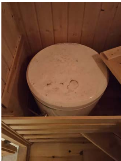
Varmtvannsbereder under benk i badstue.
