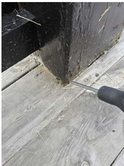
Påbegynt råde i rekkverksstolpe.
