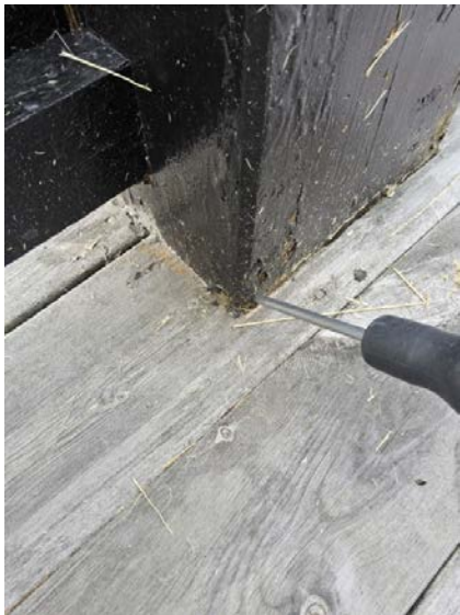
Påbegynt råde i rekkverksstolpe.
