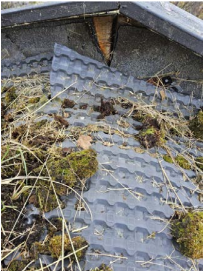
Revne i takpapp på møne.
