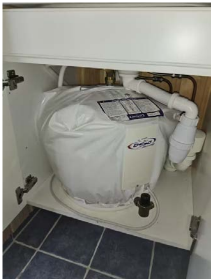
Varmtvannsbereder i anneks.
