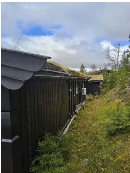
Skjevheter i takrenne på østside. Avstand
