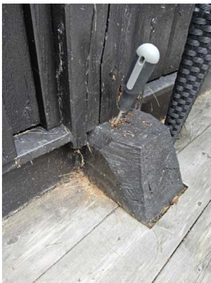
Råte i lafteknote på sørvegg.
