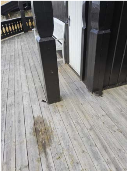
Påbegynt råte i søyle.
