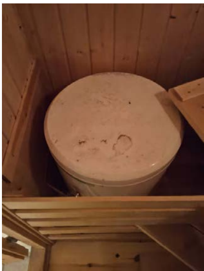
Varmtvannsbereder under benk i badstue.
