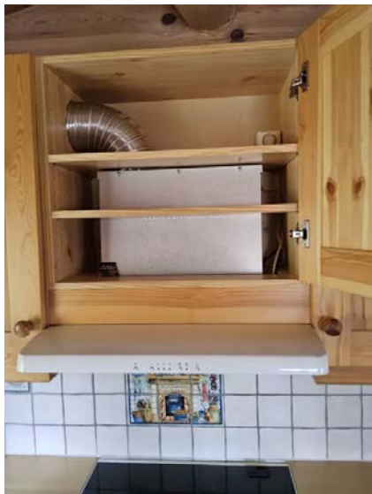
Kjøkkenvifte i overskap.
