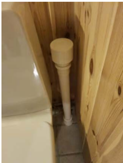
Vakuumventil plassert ved toalett.
