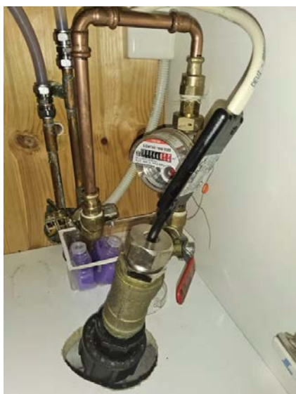
Inntaksledning med varmekabel og
