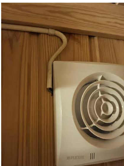
Bilde av avtrekksvifte på bad uten dobbel isolering.
