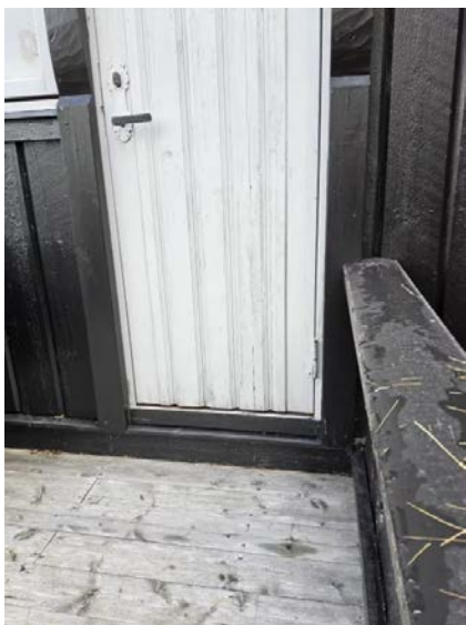
Bilde av værslitt terrassedør fra soverom.
