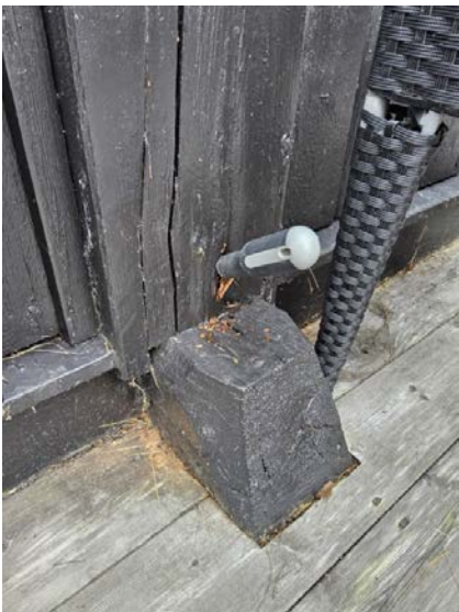
Råte i søyle på sørvegg.
