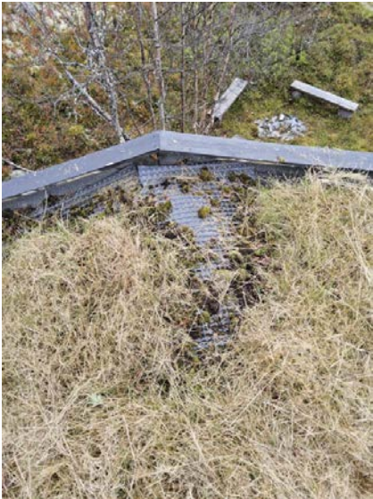
Synlig platon som følge av at torv har sklidd unna.
