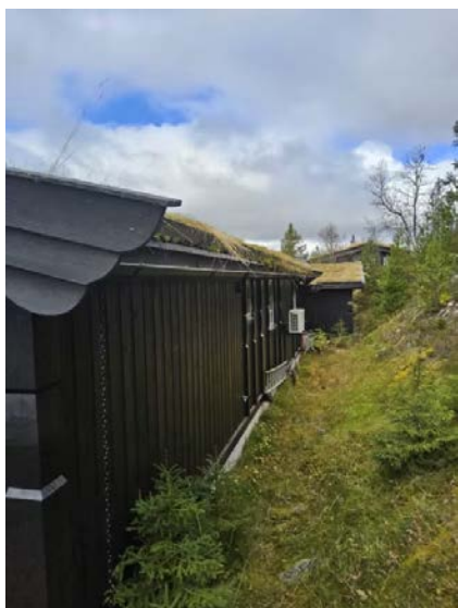
Skjevheter i takrenne på østside. Avstand
