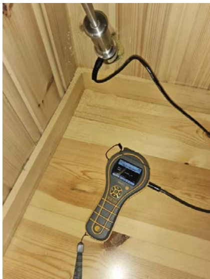
Fuktmåling mot dussjonen.
