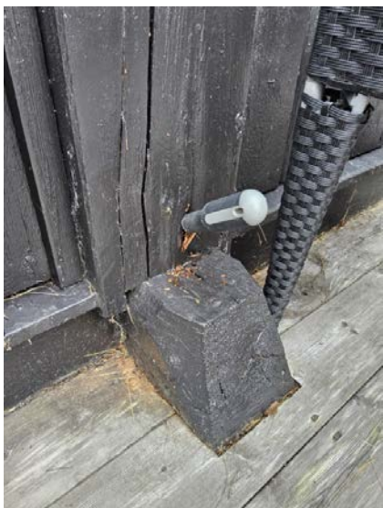
Råte i søyle på sørvegg.
