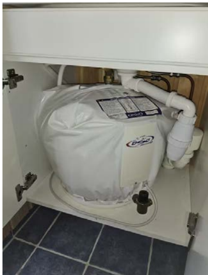
Varmtvannsbereder i anneks.
