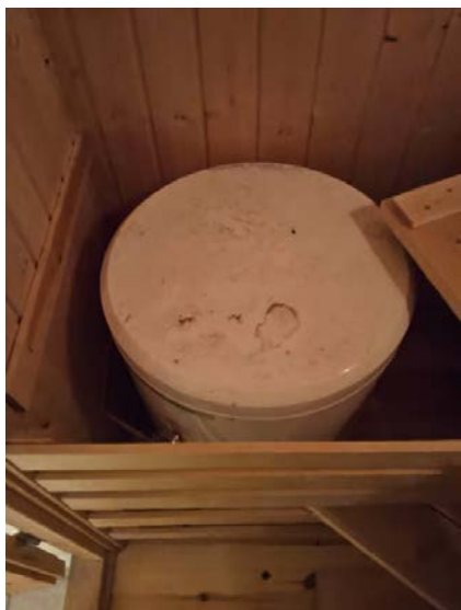
Varmtvannsbereder under benk i badstue.
