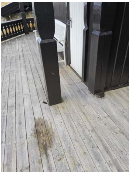
Påbegynt råde i søyle.
