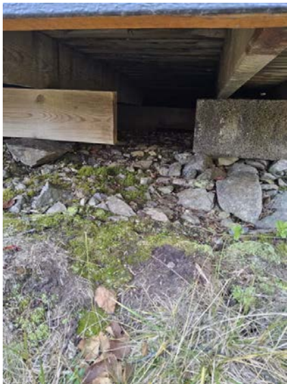
Terrassen har provisorisk fundamentering.
