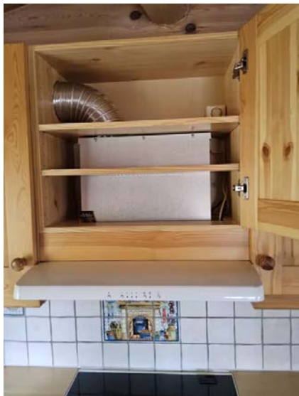
Kjøkkenvifte i overskap.
