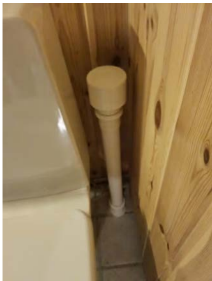
Vakuumventil plassert ved toalett.
