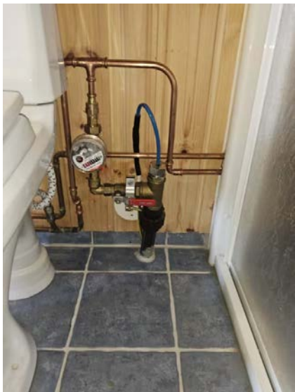
Røropplegg på bad.
