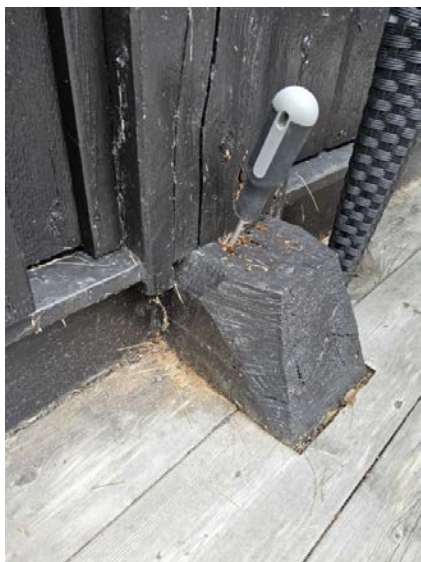
Råte i lafteknote på sørvegg.
