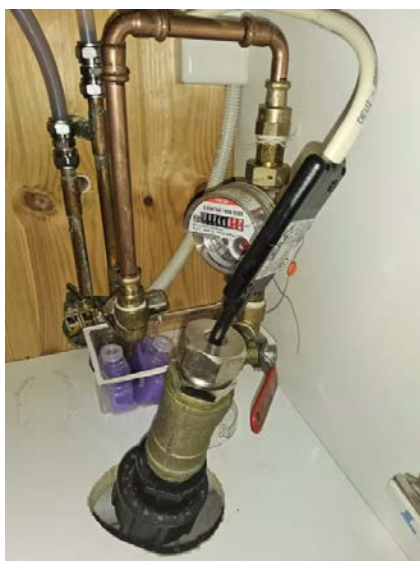
Inntaksledning med varmekabel og
