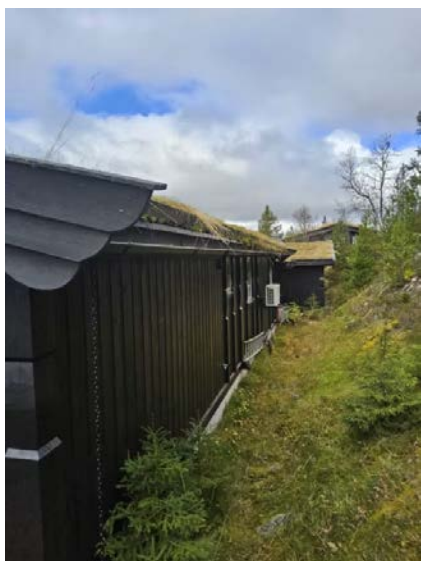
Skjevheter i takrenne på østside. Avstand
