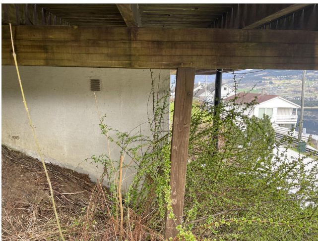
Søyla ute av lodd syner at veranda og terrasse er påført marktrykk.
