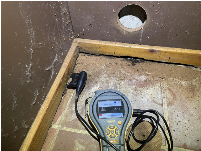
Fuktutslag ved tropp.
