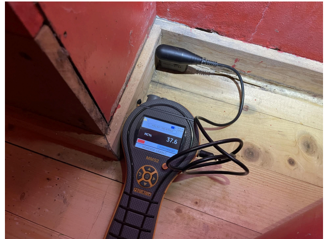
Fuktutslag under belegg på toalettrom.
