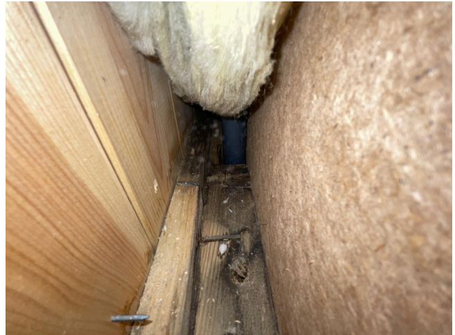
Misfargar og råte inne i vegg.
