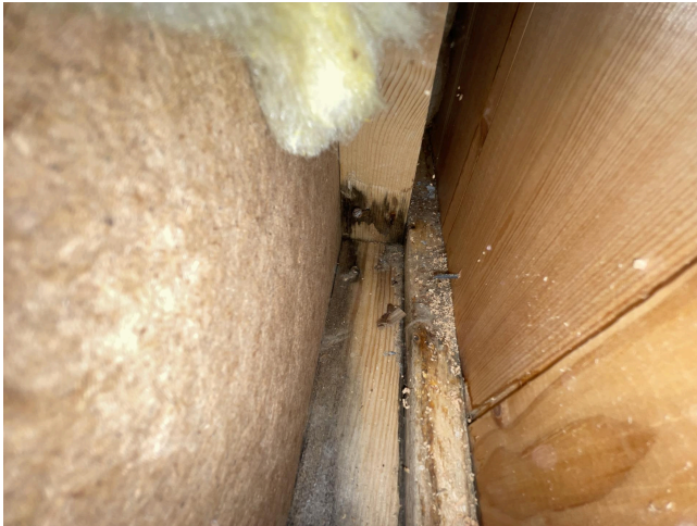
Misfargar og råte inne i vegg.
