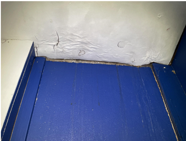
Svelling rundt pipegjennomføring.
