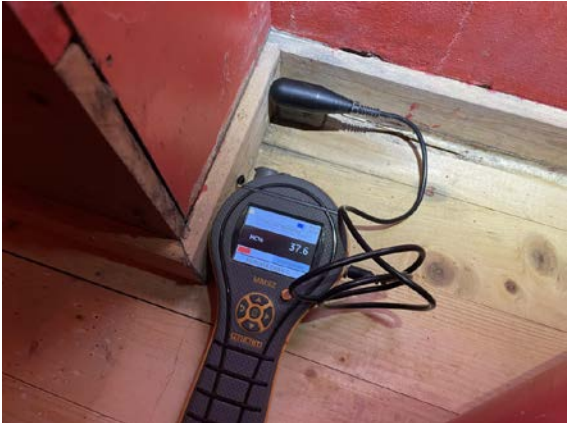
Fuktutslag under belegg på toalettrom.
