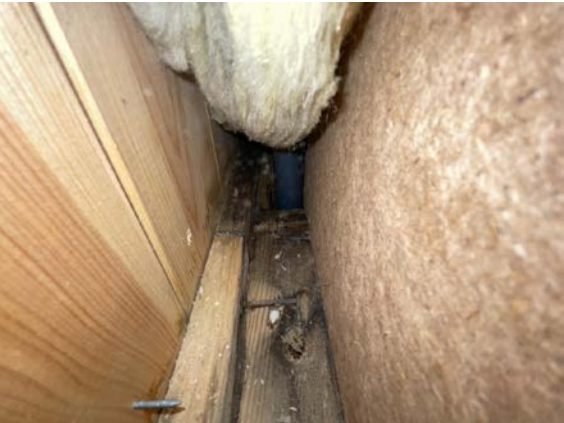
Misfargar og råte inne i vegg.
