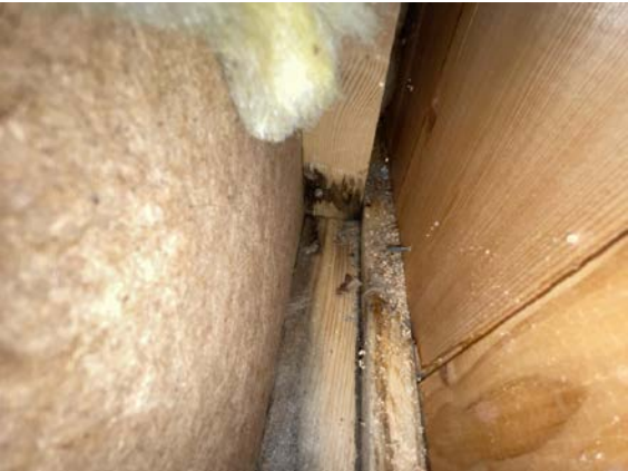
Misfargar og råte inne i vegg.
