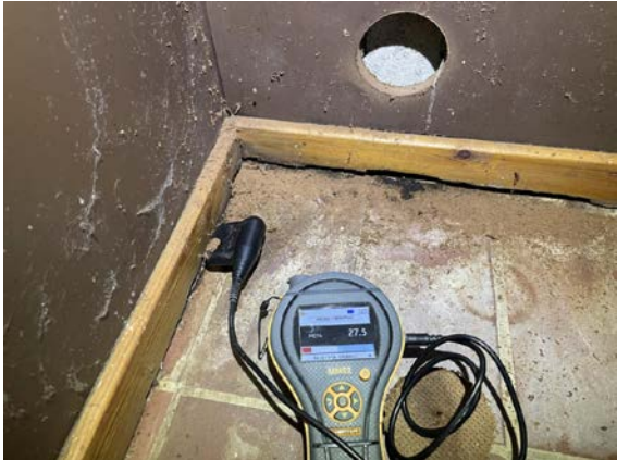
Fuktutslag ved tropp.
