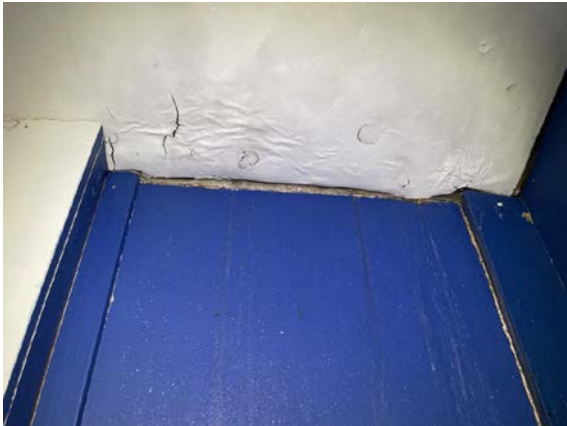
Svelling rundt pipegjennomføring.
