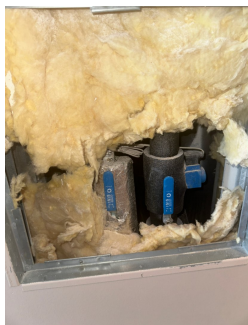
Stoppekran plassert i luke mot gang
