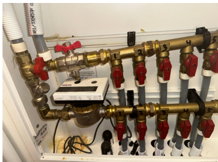
Samleskap for varmeanlegg
