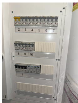
Sikringsskap med automatsikringer.
