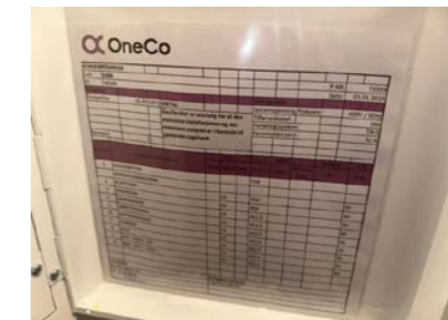
Kursoversikt i sikringsskap
