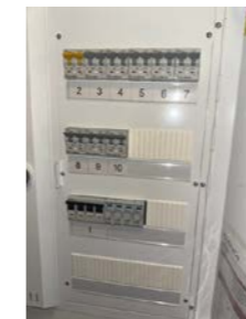
Sikringsskap med automatsikringer.
