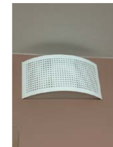
Tillufts kanaler i oppholdsrom
