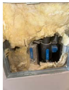
Stoppekran plassert i luke mot gang
