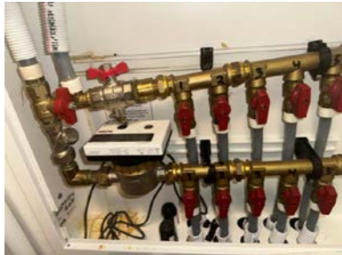
Samleskap for varmeanlegg
