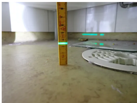
Motfall ved sluk. Referansenivå på laserhøyde ca. 1 meter ut fra sluk = 40 mm. Viser motfall på ca. 5 mm.
