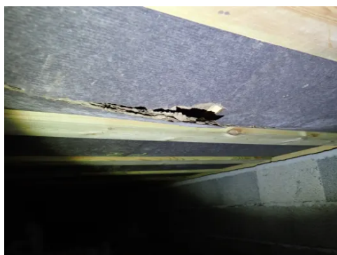
Skade i stubbloftsplate.
