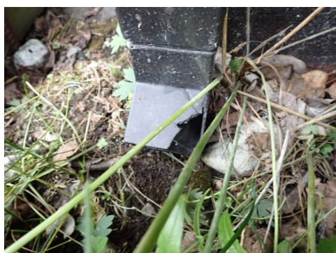
Sprekker/skade i utkast.
