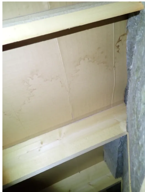
Skjolder i luftpapp på nedside av pipe.
