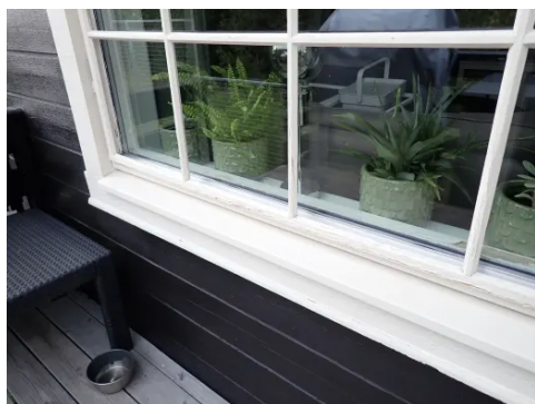
Slitasje i vinduskarmer.
