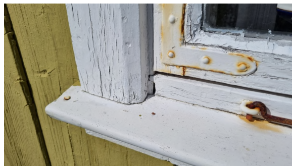
Vinduer er modne for vedlikehold.
