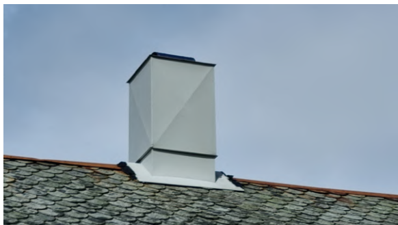
Provisorisk tetting ved pipebeslag
