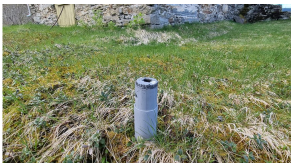
Utvendig stoppekran på vannet.
