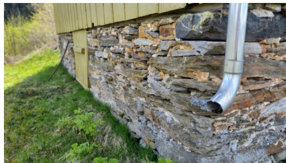
Nedløp med utkast, takvannet blir ikke ledet bort fra bygningskroppen.
