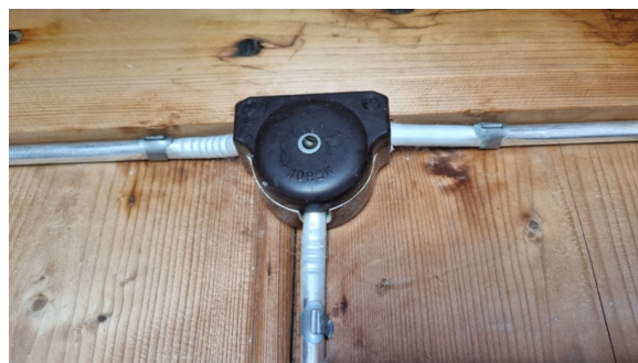
Deler av installasjonen er av eldre dato
