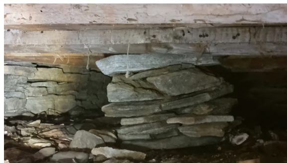
I krypkjeller er enkelte gulvbjelker understøttet av naturstein.
