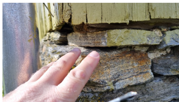
Stedvis sprekker i kledningen.
