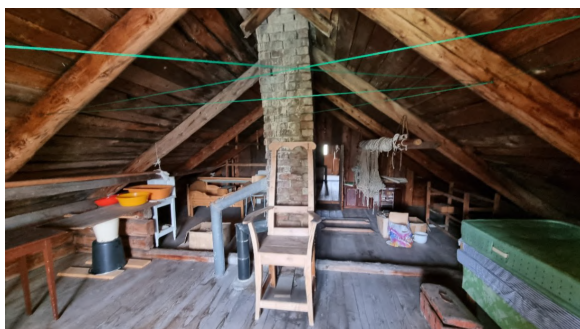
Betydelige skjevheter i pipe mot øst
