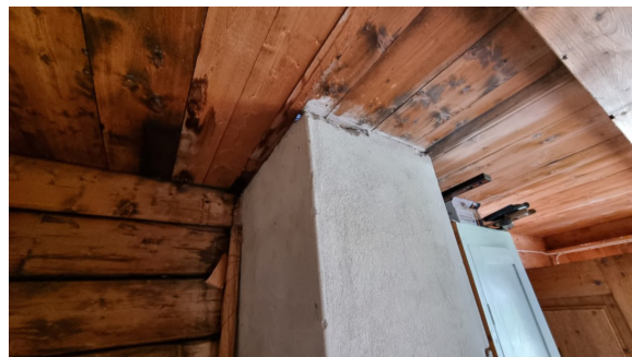
Stedvis noe fuktmerker på overflater i 2. etasje. Det ble fuktmålt i disse ved befaring, ingen unormale fuktverdier ble registrert
