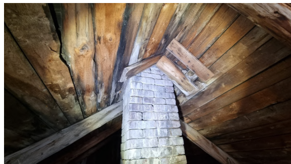
Stedvis fuktmerker i takkonstruksjonen.
