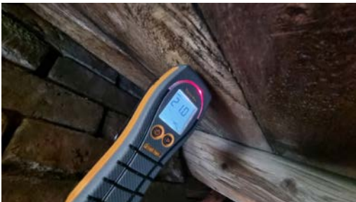
Fuktmåling i tak mot sør/øst, her ble det registrert forhøyede fuktverdier
