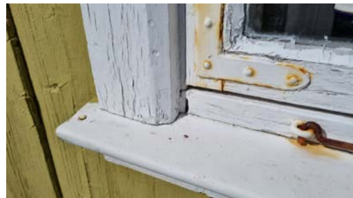
Vinduer er modne for vedlikehold.
