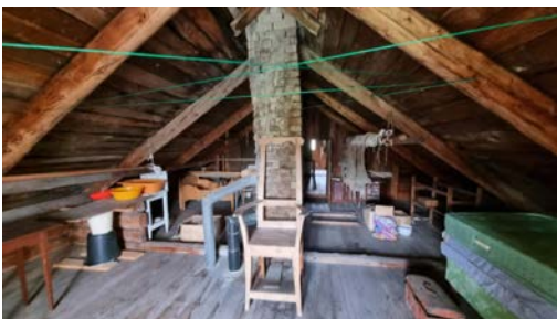
Betydelige skjevheter i pipe mot øst
