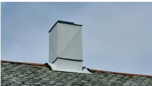
Provisorisk tetting ved pipebeslag
