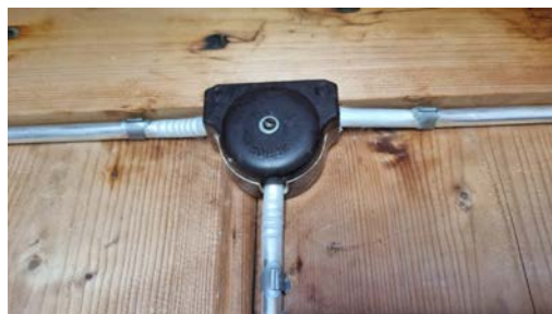
Deler av installasjonen er av eldre dato
