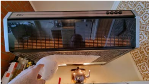
Funksjonstesting av avtrekket over komfyren.
