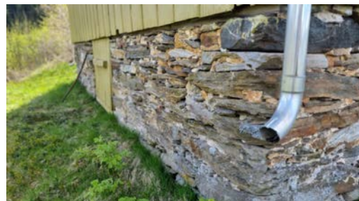
Nedløp med utkast, takvannet blir ikke ledet bort fra bygningskroppen.
