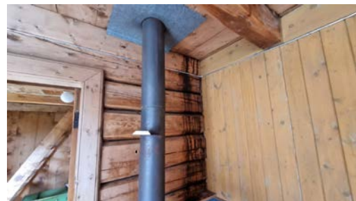
Flere røykrørgjennomføringer i etasjeskiller.
