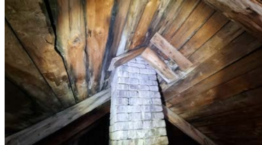
Stedvis fuktmerker i takkonstruksjonen.
