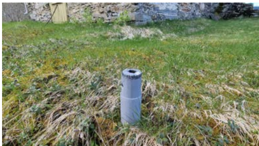
Utvendig stoppekran på vannet.
