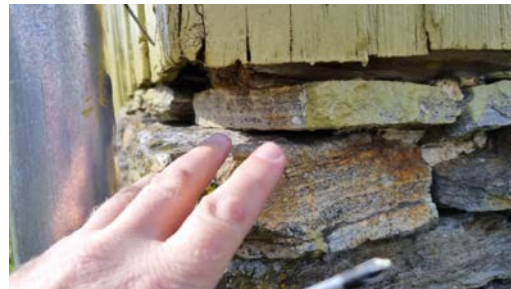
Stedvis sprekker i kledningen.
