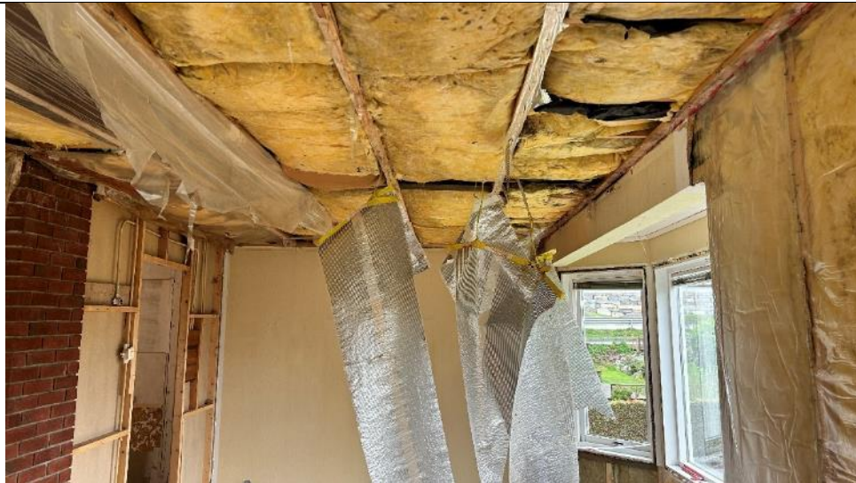
Foto nr. 45 Eswaplater revet ned. Rottedrit i himling.
