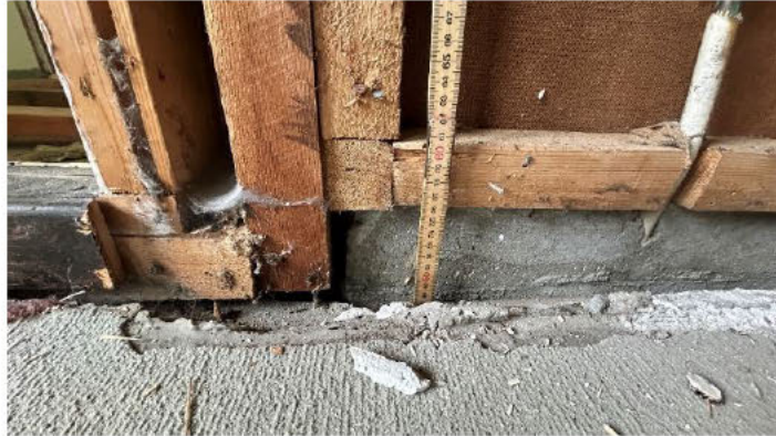
Stort hulrom under betongplate ved vegg i kjellerstue.
