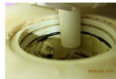
Sluk under dusjkabinett.
