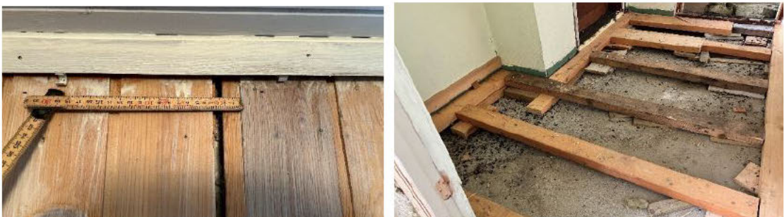
Setning har ført til at veggpanel på vaskerom har glidd langt ut fra fals. Oppforet gulv i gang kjeller viser at ca 5cm skeivhet i betonggulv er forsøkt avrettet. Også mye rottet drit i gulvet.
