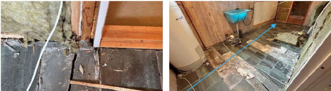
Sprekk i gulv på vaskerom. Det ble målt ca 5cm fall mot sør på vaskerom (ved pil).
