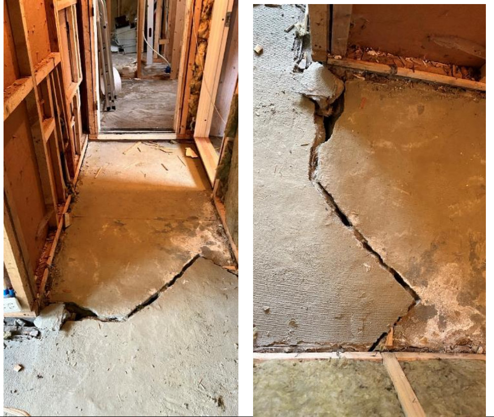
Foto nr. 21 Stor sprekk i gulv mot grunn.
