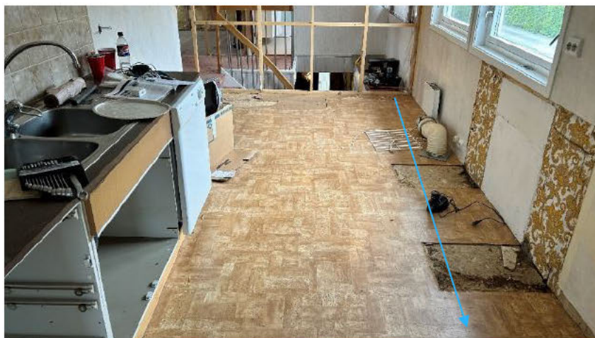
66mm fall mot nord på kjøkken.
