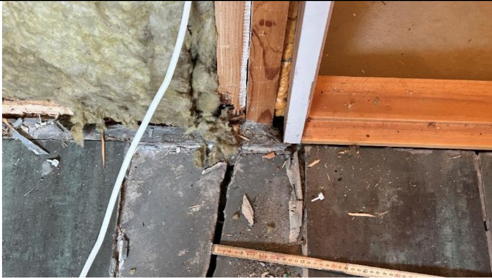
Foto nr. 25 Sprekk i gulv på vaskerom.
