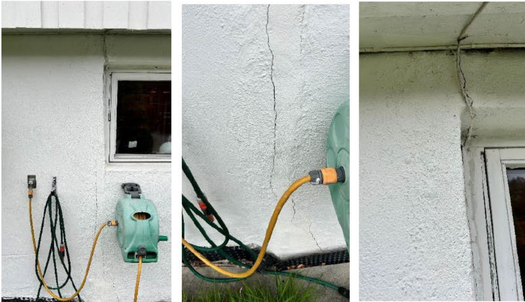
Oppsprekking i grunnmur. Sprekk er fylt igjen med sement, men sprekker fortsatt.
