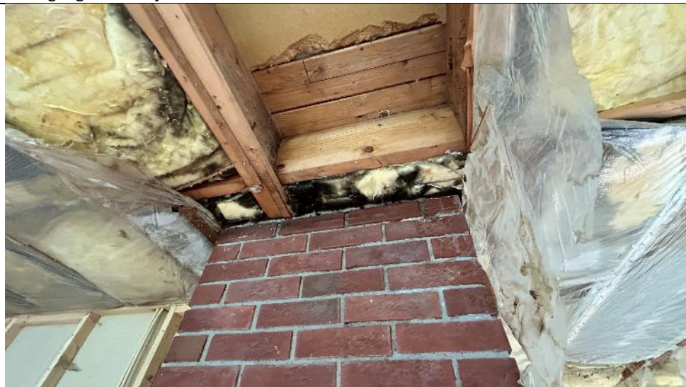
Foto nr. 49 Rotteganger i isolasjonen mot loft.
