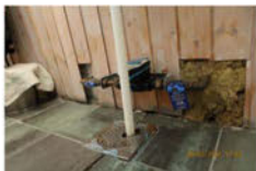
Vaskerom uten membran i gulv.
