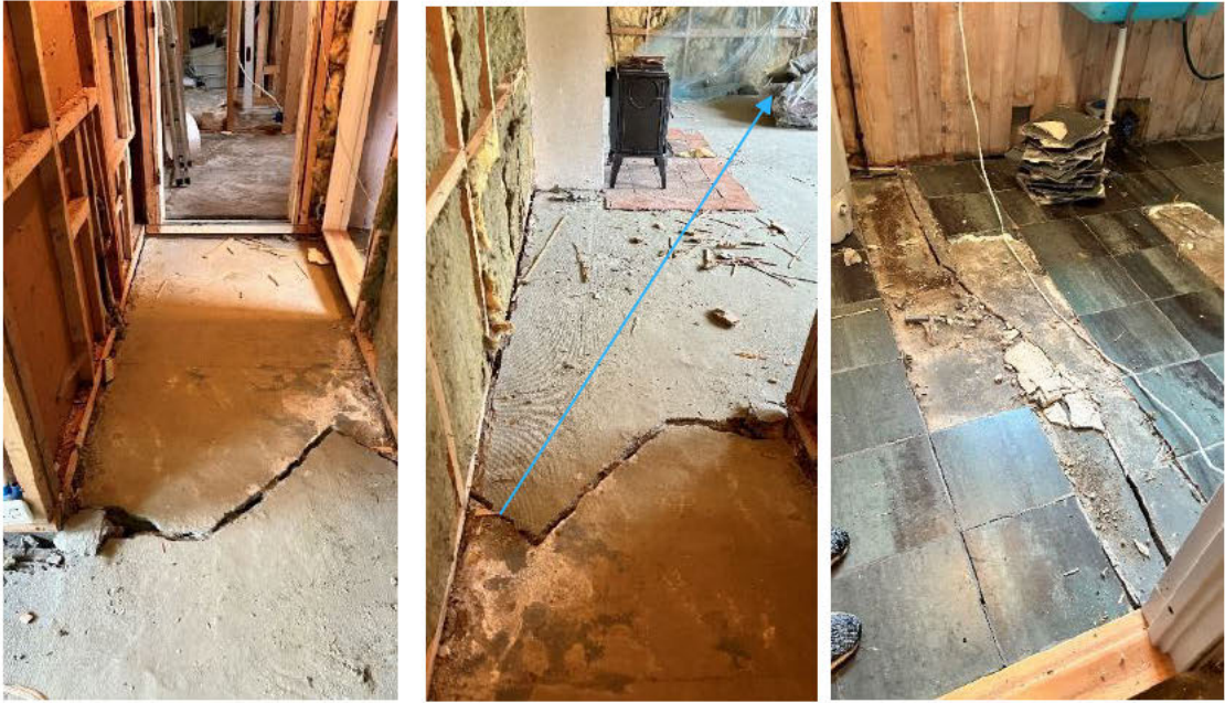
Stor sprekk på tvers av kjellergulv gjennom kjellerstue og på vaskerom. 9,5cm fall i kjellerstue (ved pil).
