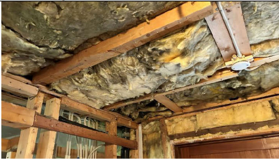
Foto nr. 31 Rotteskade i himling.
