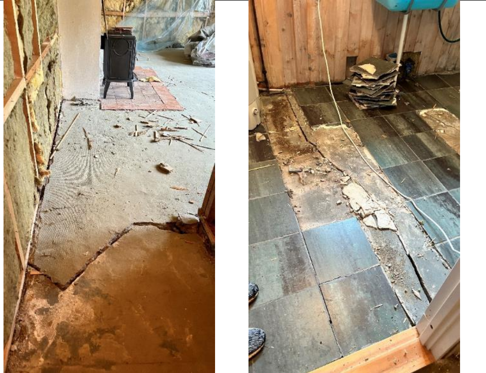
Foto nr. 22 Stor sprekk i gulv mot grunn, både i kjellerstue og gjennom vaskerom.
