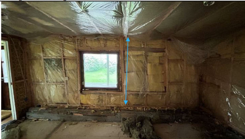
Foto nr. 32 Bindingsverk innenfor grunnmur står ca 10cm ut av lodd!
