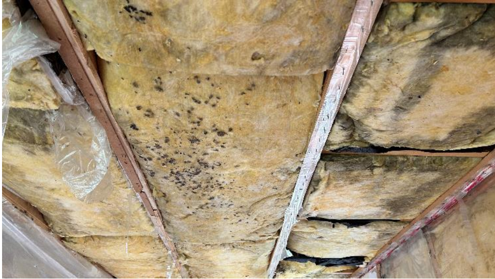
Foto nr. 46 Avføring etter rotter over stue.
