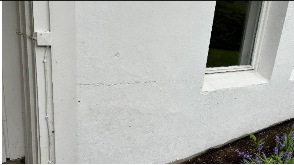
Foto nr. 7 Sprekk i grunnmur.
