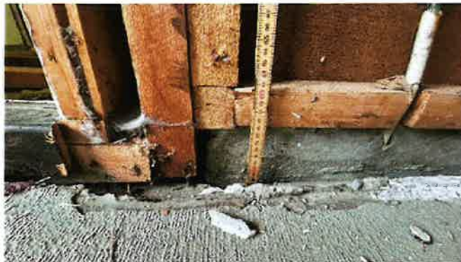
Stort hulrom under betongplate ved vegg i kjellerstue.
