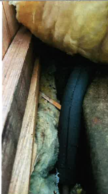
Foto nr. 59 Utkassing ved trapp fra 2. til 1.etg. Rottedrit i veggen.
