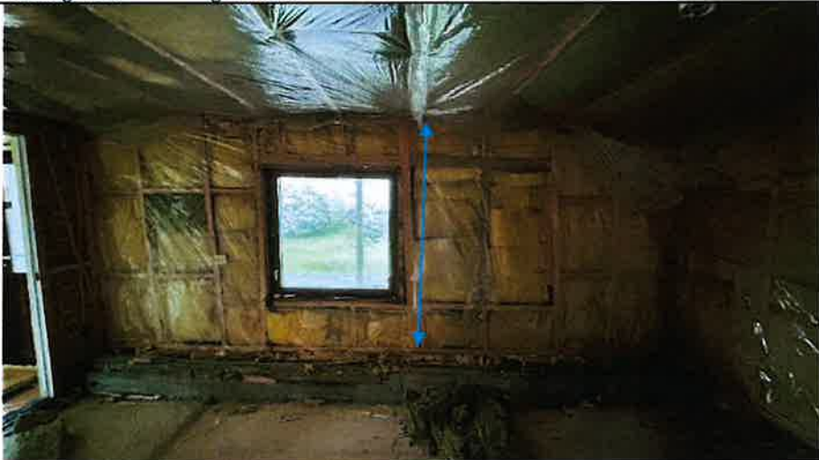
Foto nr. 32 Bindingsverk innenfor grunnmur står ca 10cm ut av lodd!
