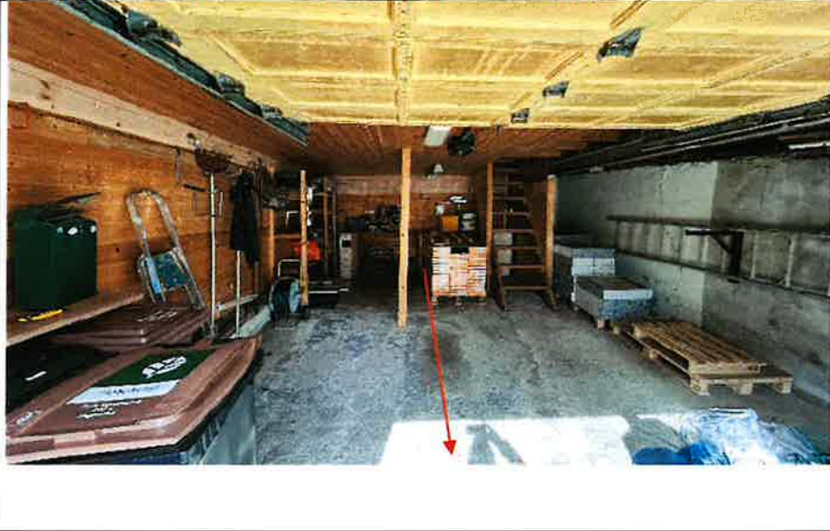
Foto nr. 64 Garasjen har helling / fall ut mot garasjeport på over 30cm jmf pil.
