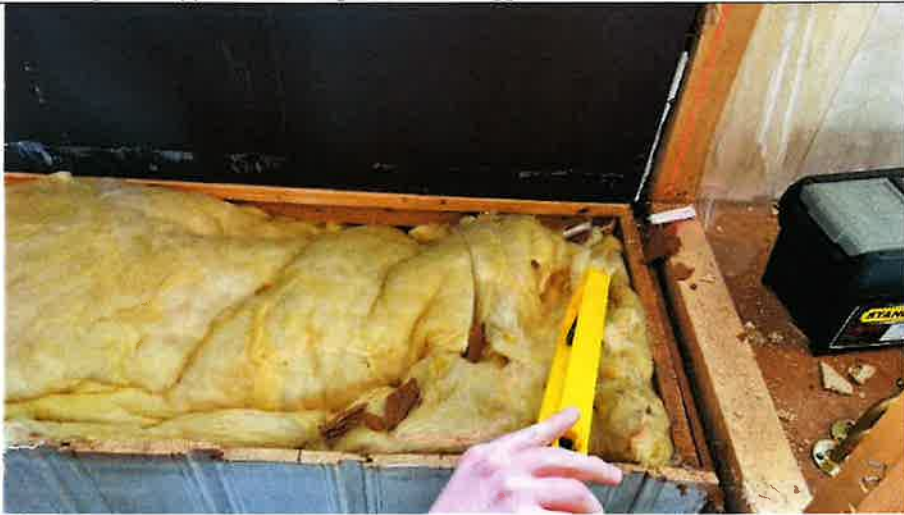
Foto nr. 58 Utkassing ved trapp fra 2. til 1.etg. Rottedrit i veggen.
