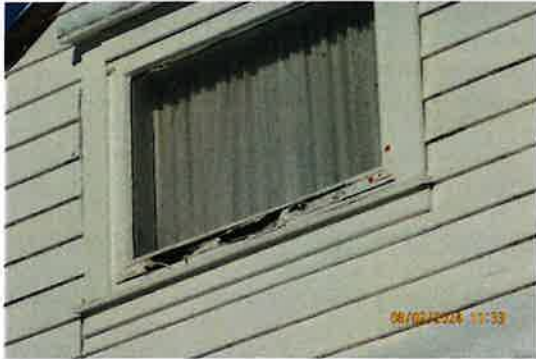
Vinduer med råteskader.
