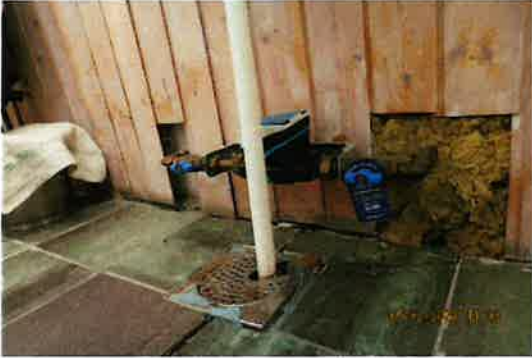
Vaskerom uten membran i gulv.
