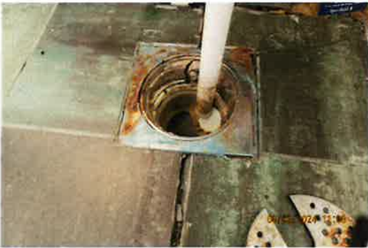
Sluk i vaskerom.
