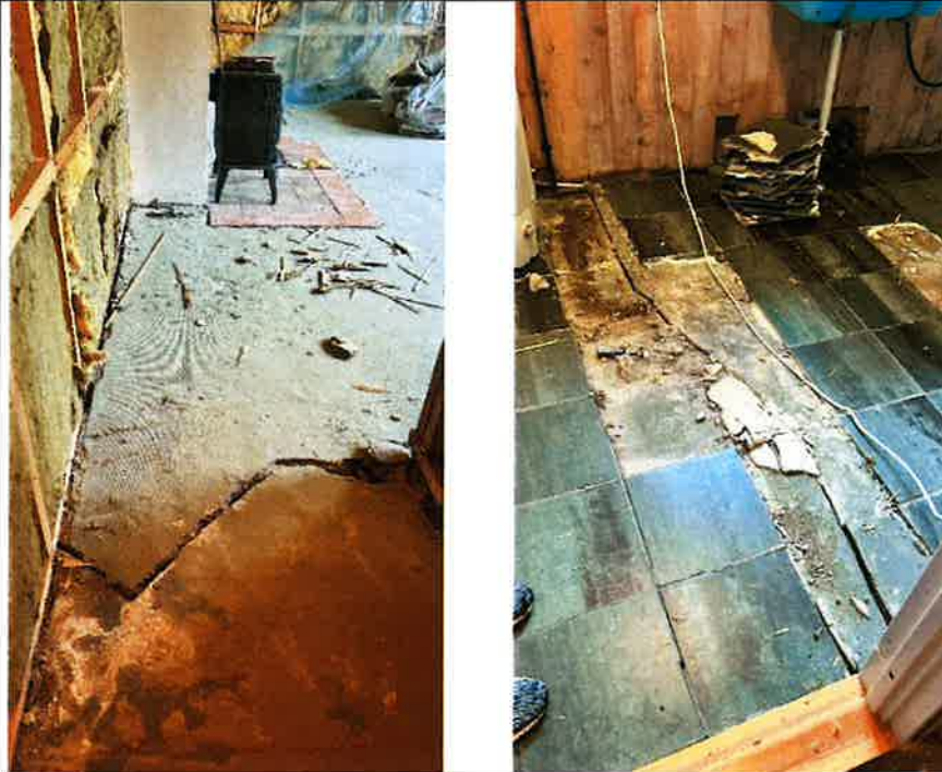
Foto nr. 22 Stor sprekk i gulv mot grunn, både i kjellerstue og gjennom vaskerom.
