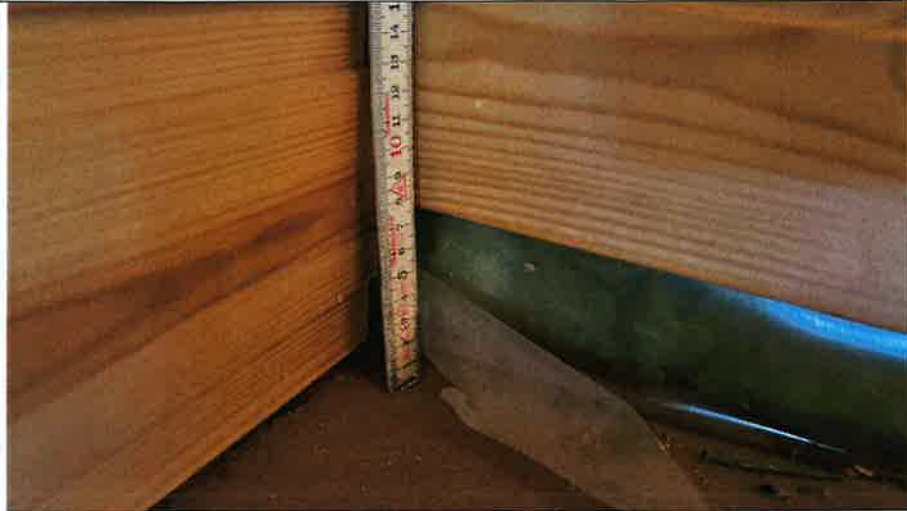
Foto nr. 54 Panel på knevegger er løftet over 7cm for å legges i våter- Gulv er altså tilsvarende skeivt her.
