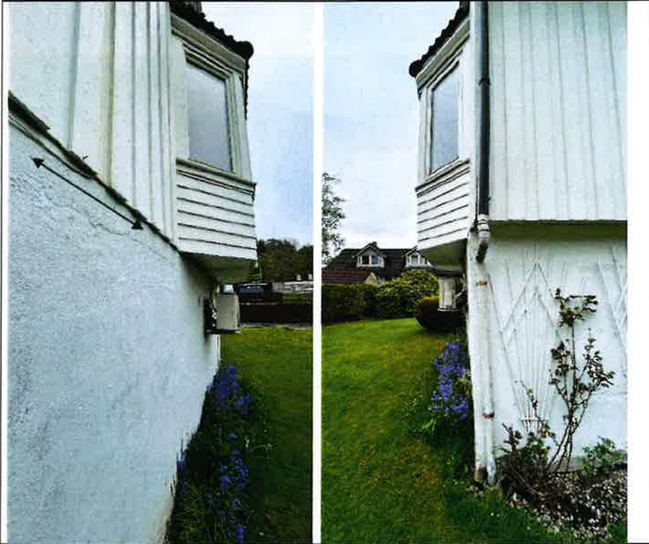
Foto nr. 3 Grunnmur er påstøpt i søndre gavl med anslagsvis 10cm.
