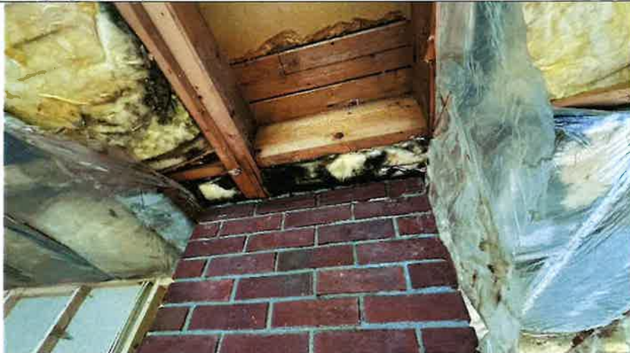
Foto nr. 49 Rotteganger i isolasjonen mot loft.
