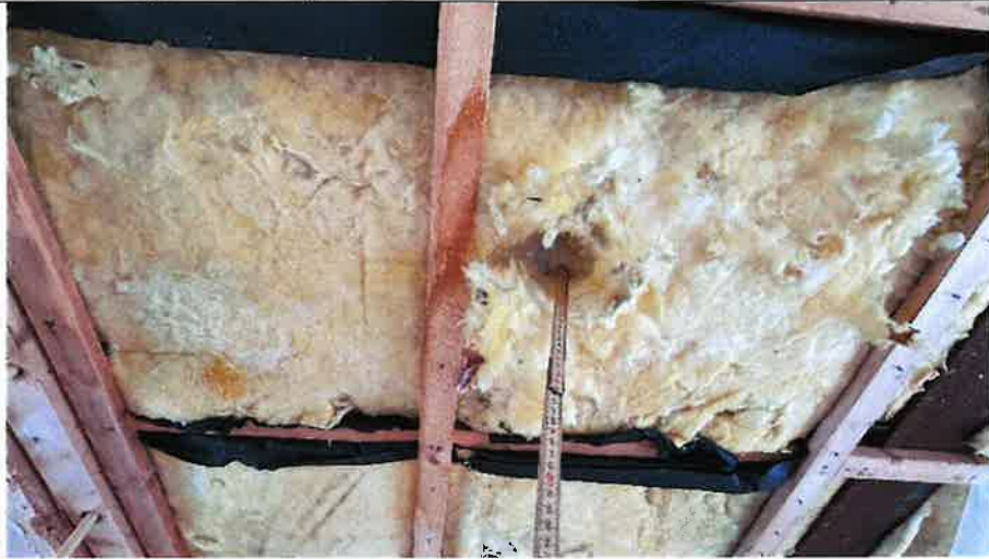
Foto nr. 50 Rotter har laget hull i isolasjonen.
