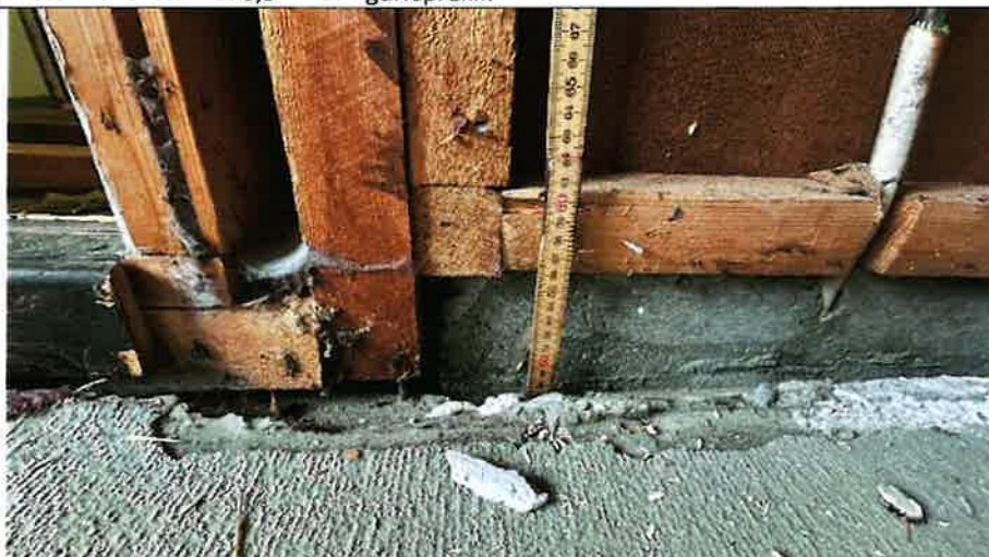
Foto nr. 26 Metermål er stukket 0,5m ned i gulvsprekk!
