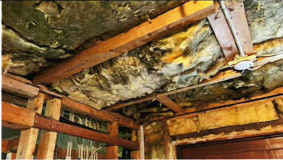
Foto nr. 31 Rotteskade i himling.
