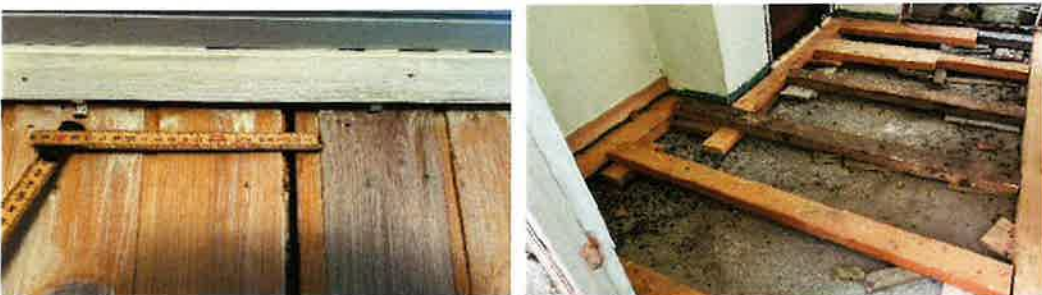
Setning har ført til at veggpanel på vaskerom har glidd langt ut fra fals. Oppforet gulv i gang kjeller viser at ca 5cm skeivhet i betonggulv er forsøkt avrettet. Også mye rottetdrit i gulvet.
