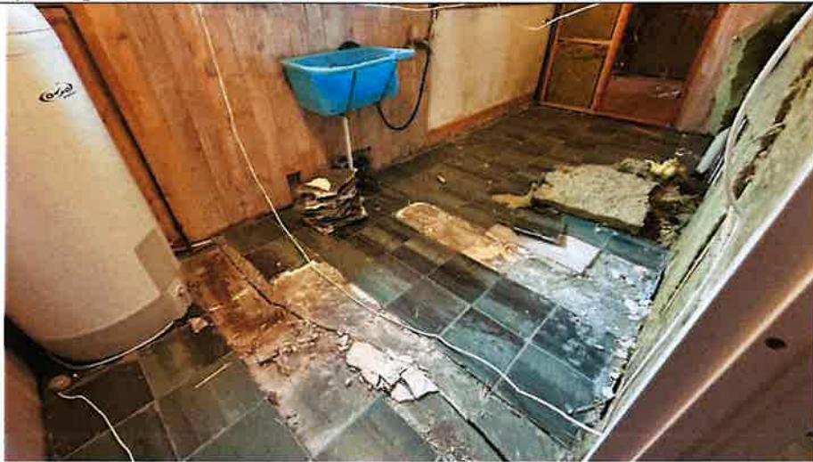
Foto nr. 23 Sprekk i gulv vaskerom.
