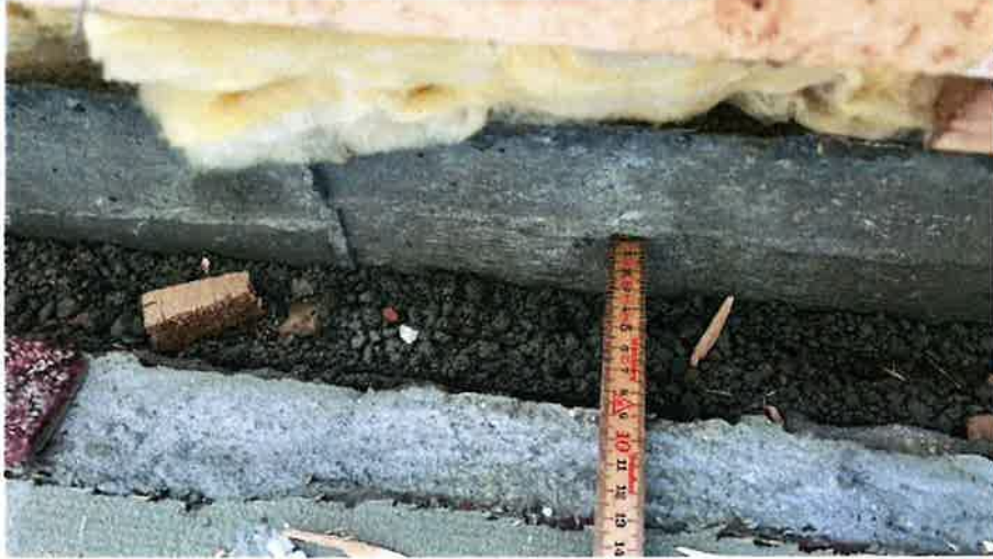
Foto nr. 39 Fundament / grunnmur har glidd ut fra betonggulv ca 5cm. Sprekk i betonggulv.
