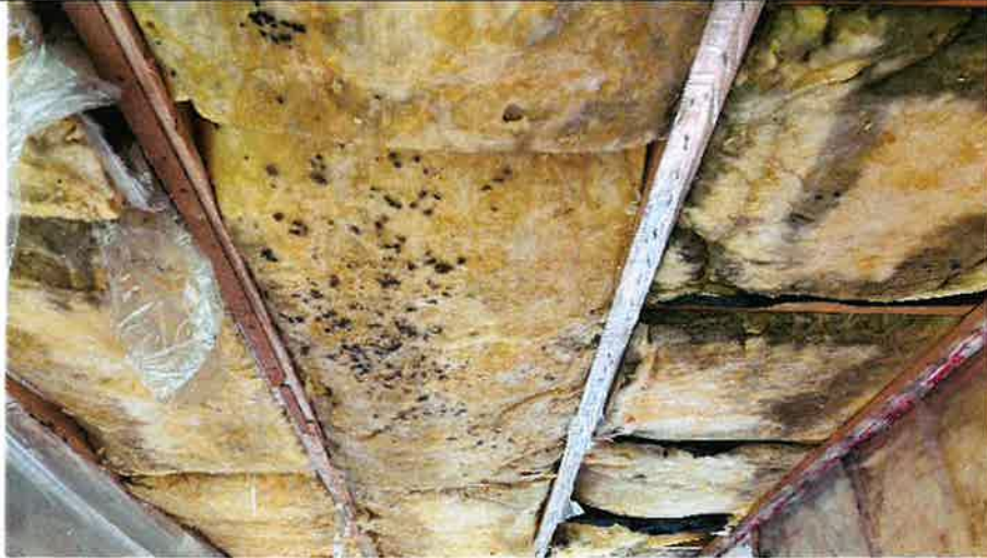
Foto nr. 46 Avføring etter rotter over stue.
