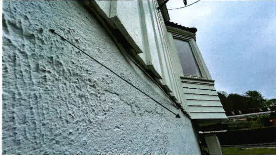
Foto nr. 5 Grunnmur er påstøpt ca 10cm i søndre gavl.
