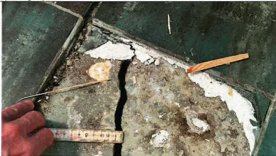
Foto nr. 24 Sprekk i gulv på vaskerom.
