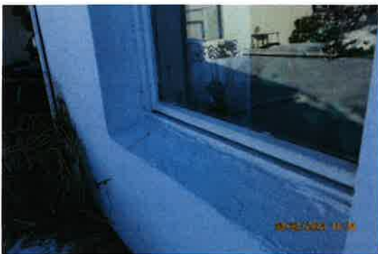
Vinduer med råteskader.
