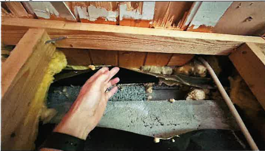
Foto nr. 43 Foto tatt i topp av grunnmur mot sør. Det er lagt lecamur oppå grunnmur ifm oppretting.
