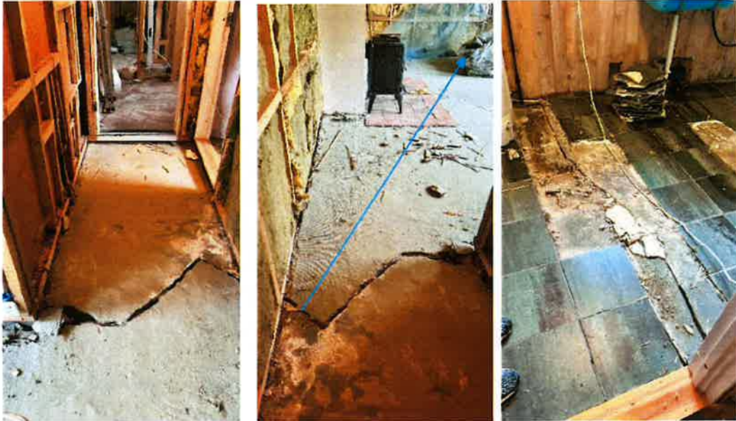
Stor sprekk på tvers av kjellergulv gjennom kjellerstue og på vaskerom. 9,5cm fall i kjellerstue (ved pil).
