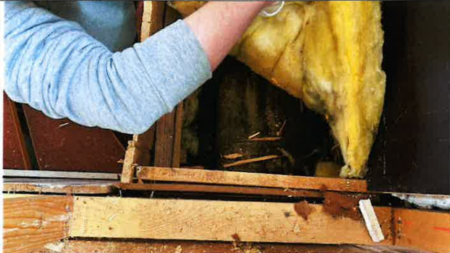
Foto nr. 60 Utkassing ved trapp fra 2. til 1.etg. Rottedrit i veggen.
