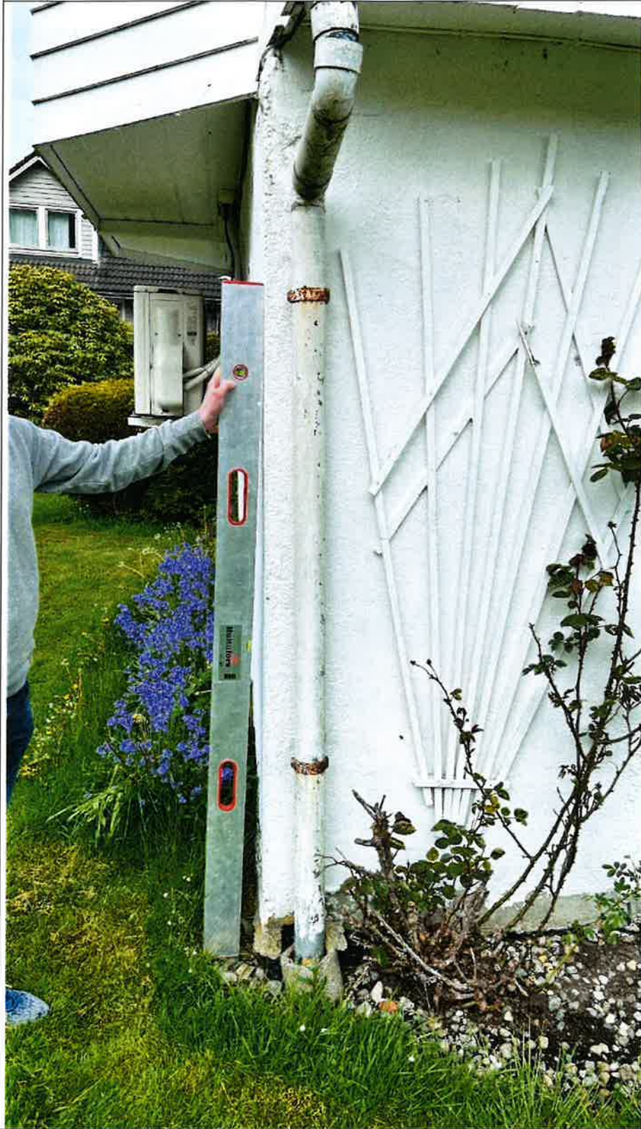
Foto nr. 16 Søndre gavlvegg heller ca 6 cm mot sør, jmf neste foto.
