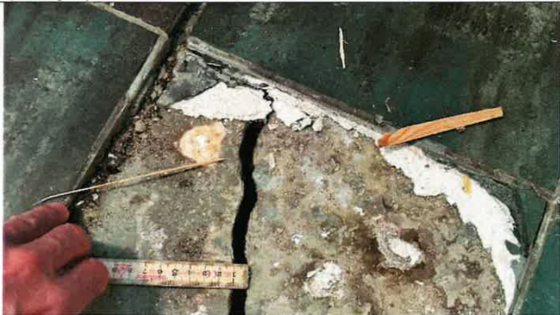
Foto nr. 24 Sprekk i gulv på vaskerom.
