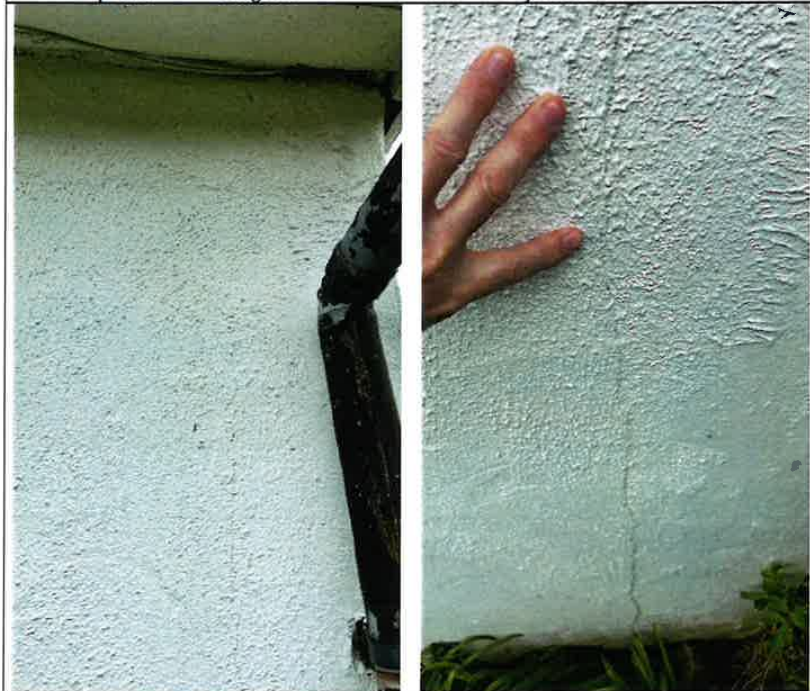
Foto nr. 6 Vertikal sprekk i vestre langside ca 20-25cm fra søndre hjørne.
