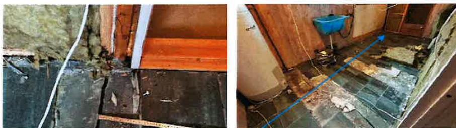
Sprekk i gulv på vaskerom. Det ble målt ca 5cm fall mot sør på vaskerom (ved pil).
