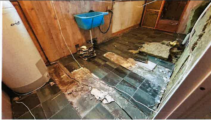
Foto nr. 23 Sprekk i gulv vaskerom.
