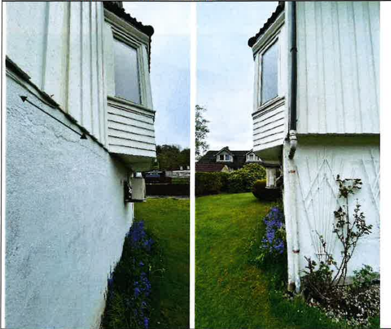
Foto nr. 3 Grunnmur er påstøpt i søndre gavl med anslagsvis 10cm.
