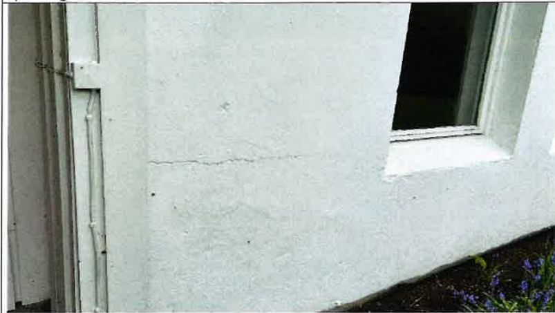
Foto nr. 7 Sprekk i grunnmur.
