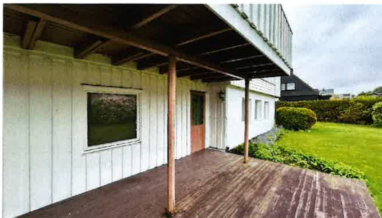
Mulig rotteinnngang inn under terrasse og videre inn under grunnmur.
