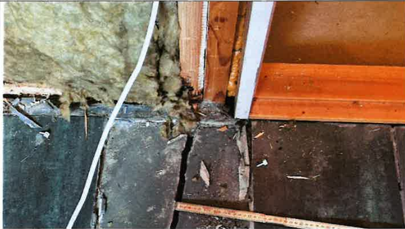
Foto nr. 25 Sprekk i gulv på vaskerom.
