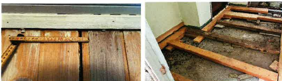
Setning har ført til at veggpanel på vaskerom har glidd langt ut fra fals. Oppforet gulv i gang kjeller viser at ca 5cm skeivhet i betonggulv er forsøkt avrettet. Også mye rottetrit i gulvet.
