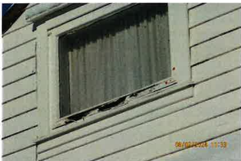
Vinduer med råteskader.
