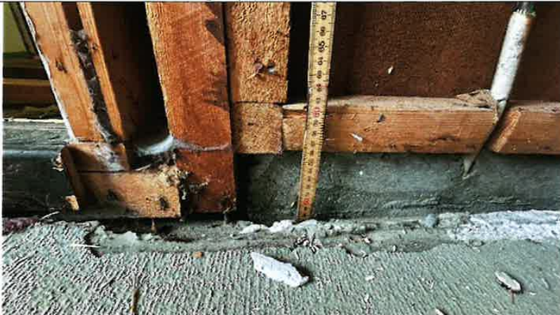
Foto nr. 26 Metermål er stukket 0,5m ned i gulvsprekk!
