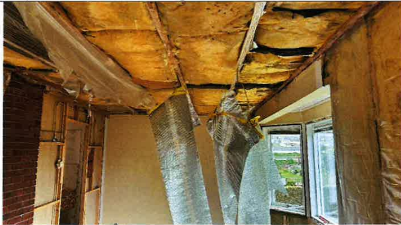
Foto nr. 45 Eswaplater revet ned. Rottedrit i himling.
