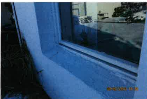
Vinduer med råteskader.
