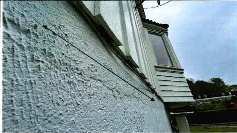
Foto nr. 5 Grunnmur er påstøpt ca 10cm i søndre gavl.
