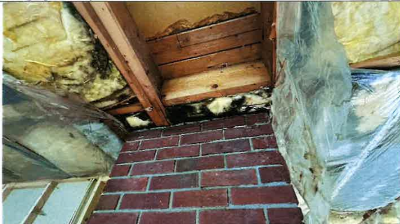
Foto nr. 49 Rotteganger i isolasjonen mot loft.
