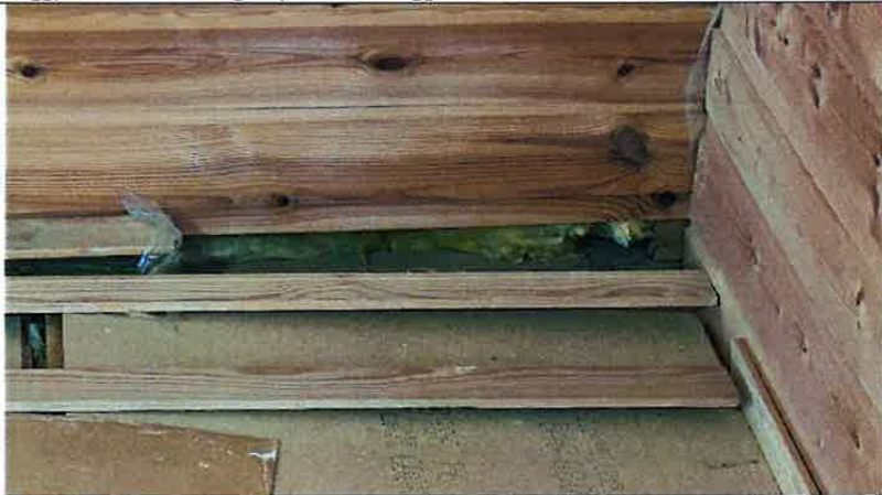
Foto nr. 55 Veggpanel er løftet fra gulv på loft for å ligge i vater.
