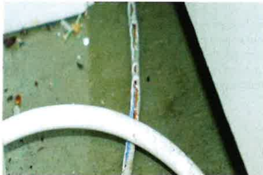
Rottegnaging på strømledninger øker faren for kortslutning og brann. FHI - Reidar Mehl
