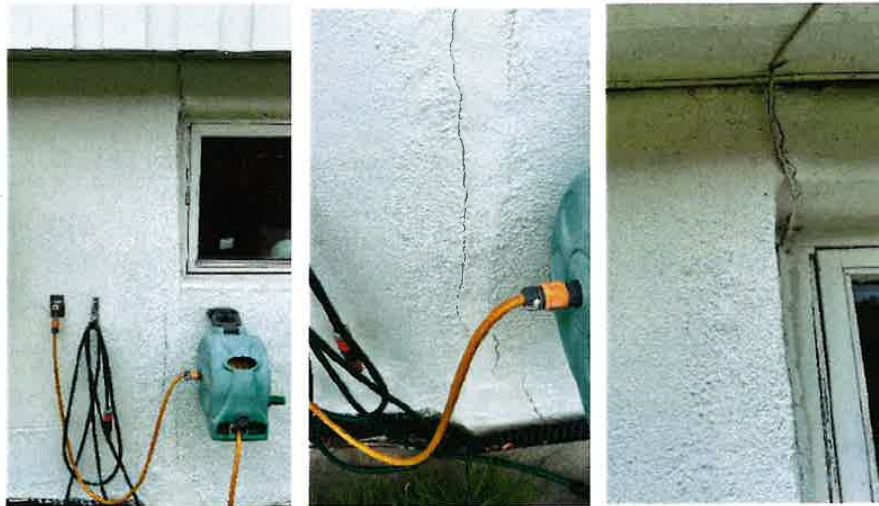
Oppsprekking i grunnmur. Sprekk er fylt igjen med sement, men sprekker fortsatt.
