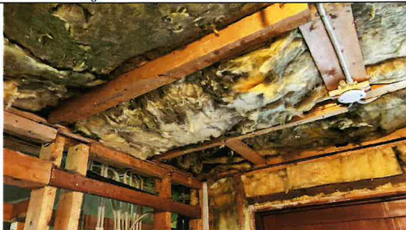
Foto nr. 31 Rotteskade i himling.
