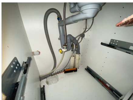
Røropplegg under kjøkkenbenk
