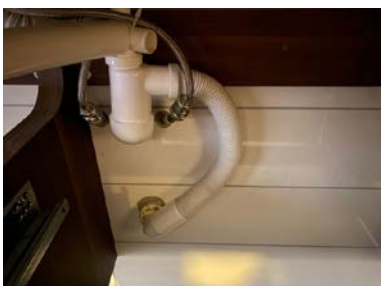
Røropplegg under vask på bad
