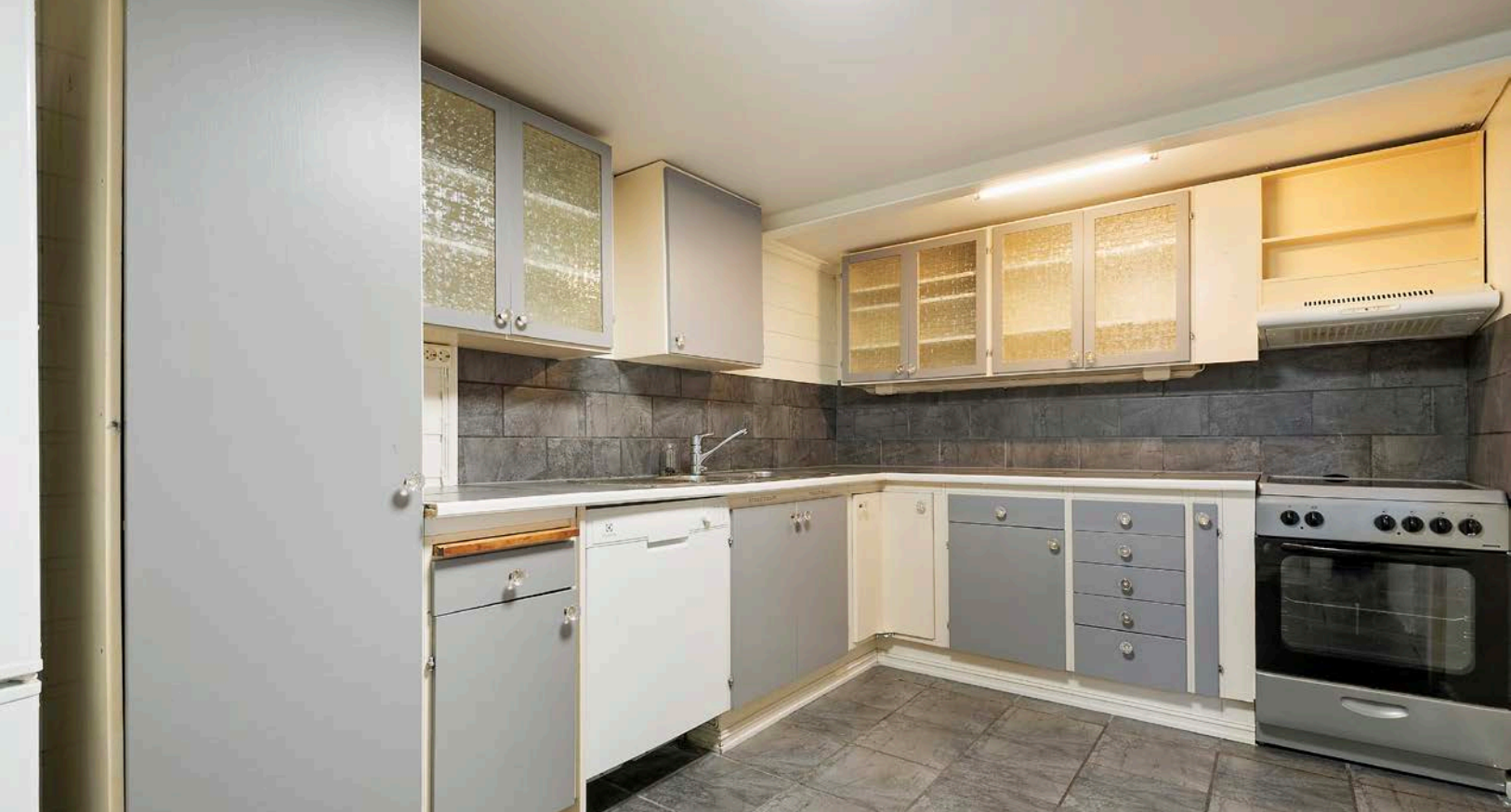
Innredet kjøkken i kjeller. Ikke bruksendret.
