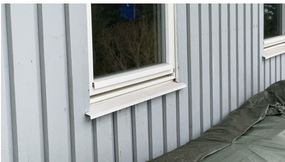
Omramming rundt vinduer er ført ned på beslag, risiko for fuktopptrekk i treverket.
