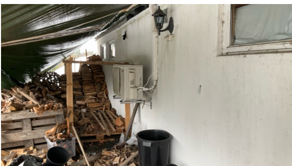
Vann fra varmepumpe bør ledes bort fra bygningen.
