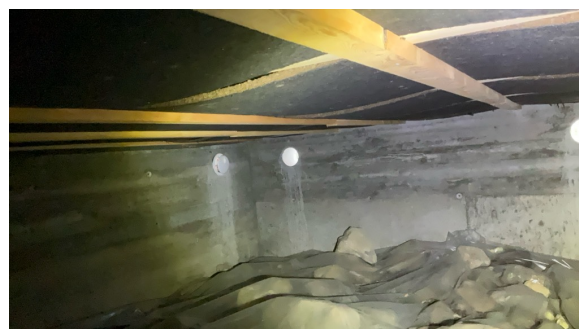
Kryperom fremstod som luftig på befaringsdagen.
