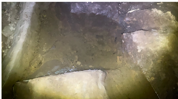
Synlig fukt på grunn flere steder i kryperommene.
