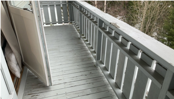
Konstruksjoner/overflater er værslitte.
