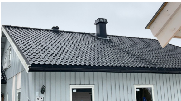
Det mangler snøfanger på hele/deler av takflatene.
