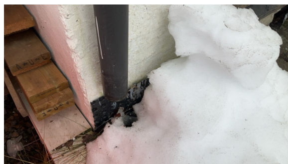
Takvannet ledes ikke vekk fra bygningen.
