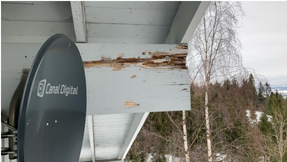
Råteskader i limtredegrager.
