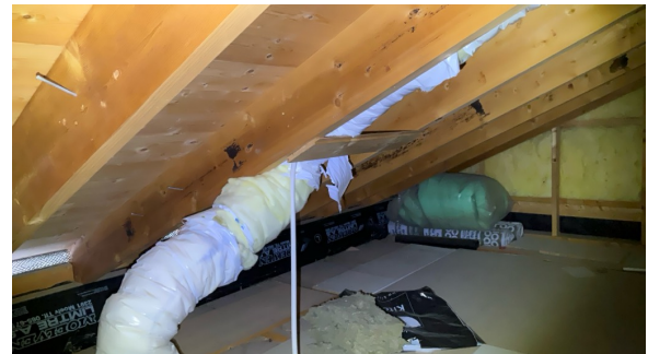
Ødelagt plast rundt isolasjonen på ventilasjonskanaler.
