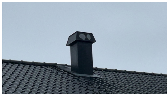
Flassing på takrenner/beslag.
