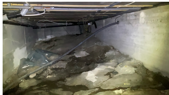
Synlig fukt på grunn flere steder i kryperommene.
