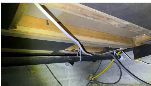
Stedvis manglende isolasjon i etasjeskille mot kryperom.
