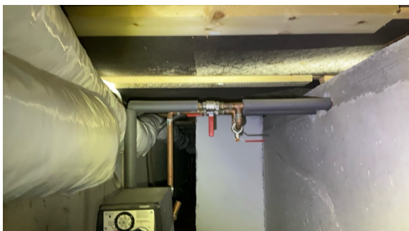
Innvendig hovedstoppekran er plassert i krypekjeller.
