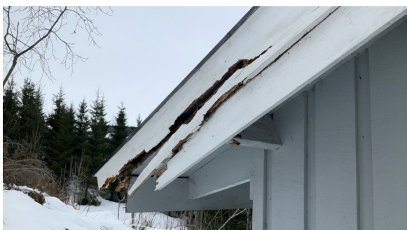
Råteskadet treverk i vindski er registrert.
