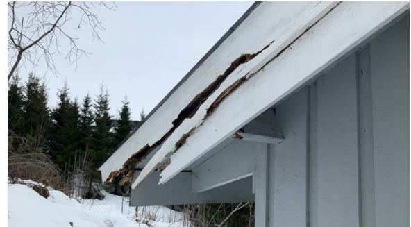
Det må gjøres ytterligere undersøkelser av takkonstruksjon og vegg i dette området hvor det er påvist råteskader.
