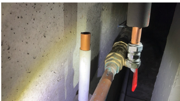
Enkelte rør var koblet i fra på befaringdagen.
