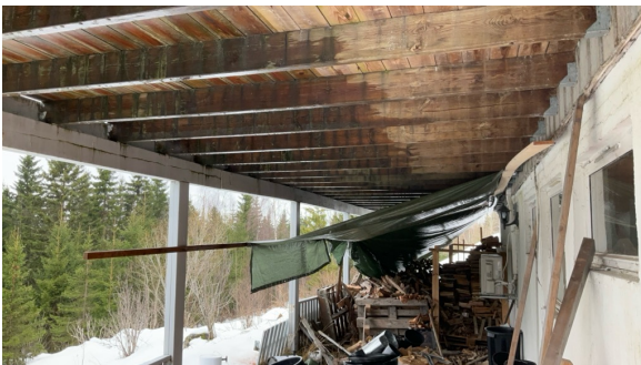
Konstruksjonen fremstår som underdimensjonert.
