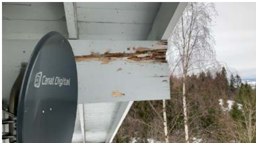
Råteskader i limtredeger.
