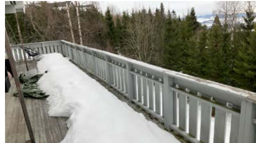
Overflater er delvis dekket med snø på befaringsdagen og er derfor ikke vurdert.
