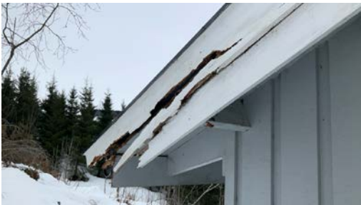
Råteskadet treverk i vindski er registrert.
