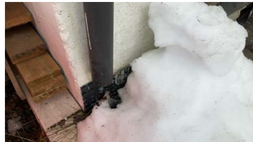
Takvannet ledes ikke vekk fra bygningen.
