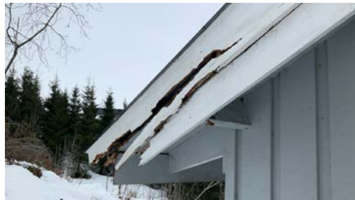
Det må gjøres ytterligere undersøkelser av takkonstruksjon og vegg i dette området hvor det er påvist råteskader.
