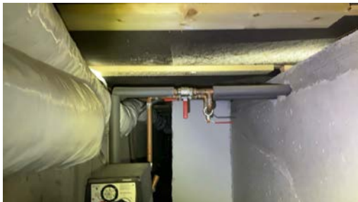
Innvendig hovedstoppekran er plassert i krypekjeller.
