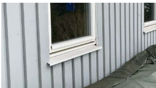
Omramming rundt vinduer er ført ned på beslag, risiko for fuktopptrekk i treverket.
