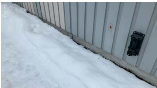
Viktig å følge med på ventiler som ligger helt ned mot terrenget slik at det ikke oppstår vannskader.
