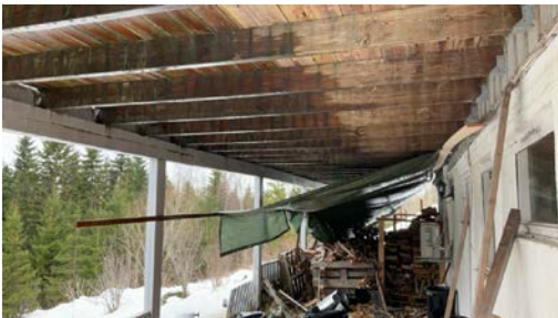
Konstruksjonen fremstår som underdimensjonert.
