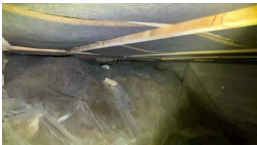
Liten del har lav høyde mellom grunnen og bjelkelag, dette er forhold som kan gi økt risiko for skader.
