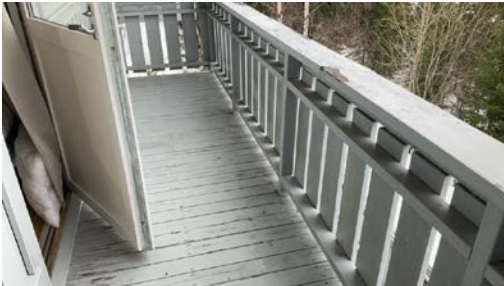
Konstruksjoner/overflater er værslitte.
