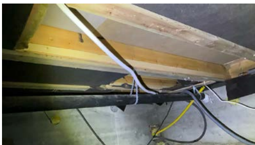
Stedvis manglende isolasjon i etasjeskille mot kryperom.
