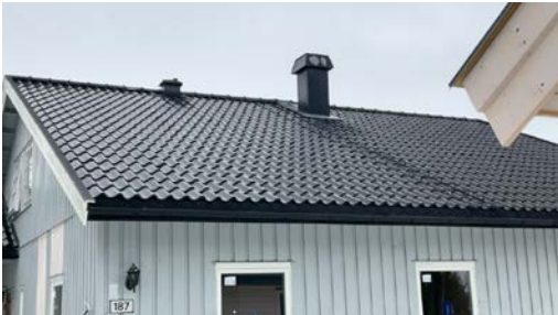
Det mangler snøfanger på hele/deler av takflatene.
