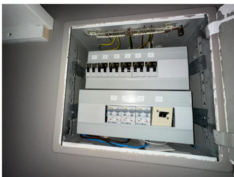
Sikringskapp med automatsikringer.
