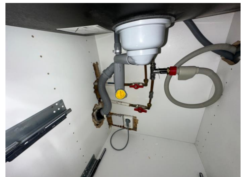
Røropplegg i kjøkkenbenk
