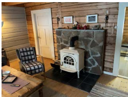
Ovn med brannmur på stue
