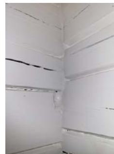
Innvendige hjørner er påsmurt tettemasser.
