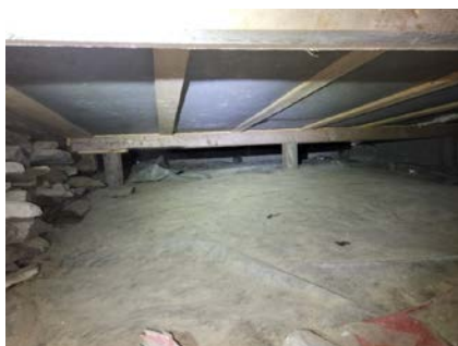
Dampsperre på grunn.
