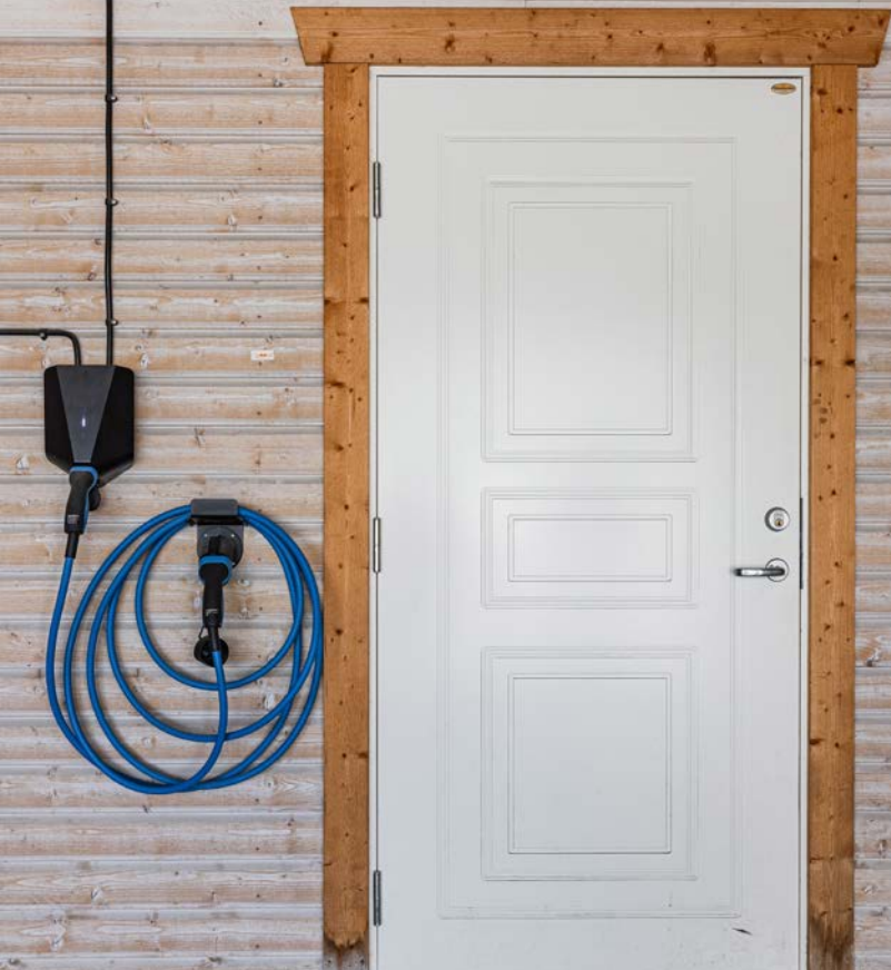
Det er montert elbil-lader i carporten. I bakkant av carporten er det bod på ca. 4 m 2 .
