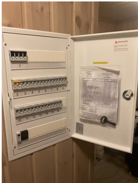
Sikringskap er plassert i tekniskrom/bod.
