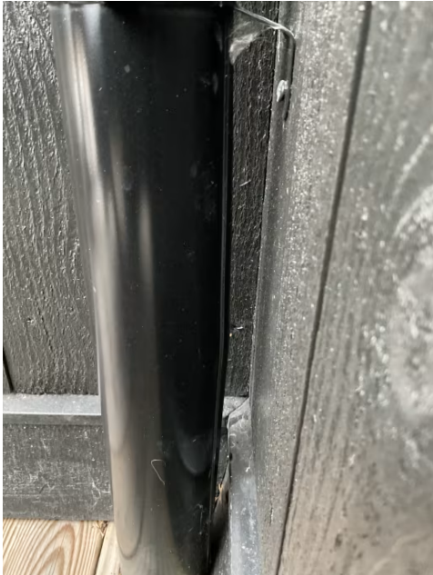
Frostspreg i nedløp.
