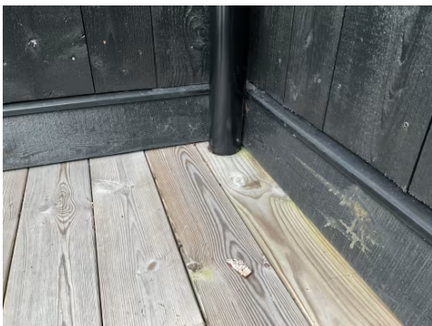
Ukjent drenering under terrasser.
