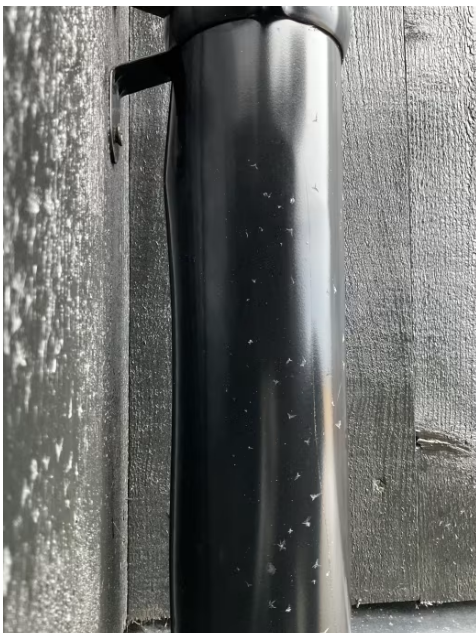
Frostspreg i nedløp.
