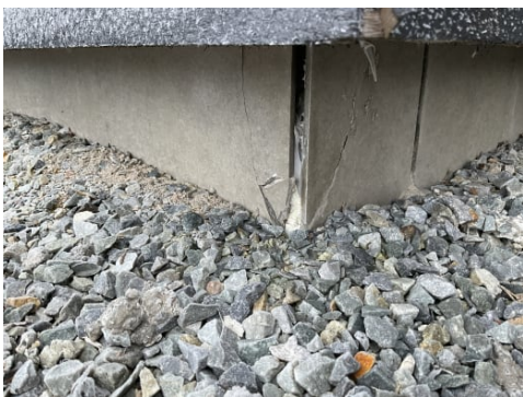
Skade på ringmur.
