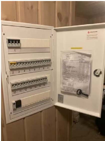
Sikringskap er plassert i tekniskrom/bod.
