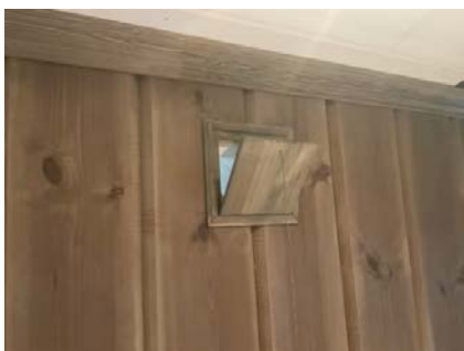
Klaffventil i vegg.
