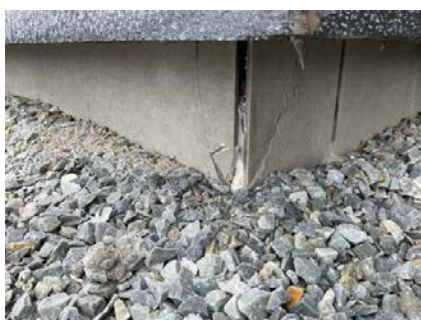
Skade på ringmur.
