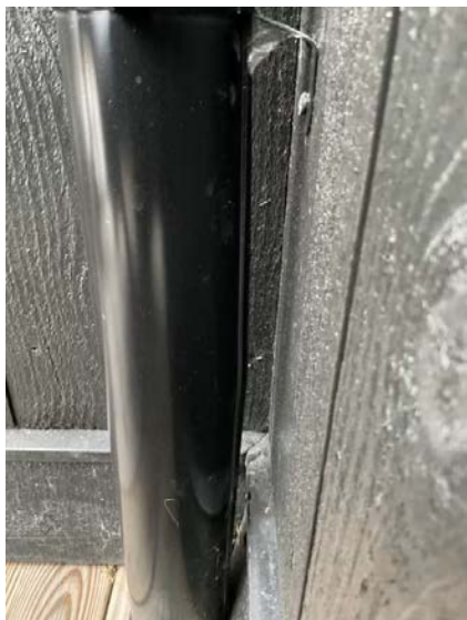
Frostspreng i nedløp.
