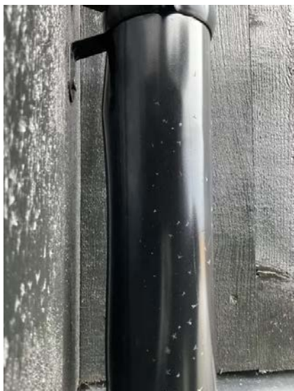
Frostspreng i nedløp.
