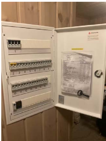
Sikringskap er plassert i tekniskrom/bod.
