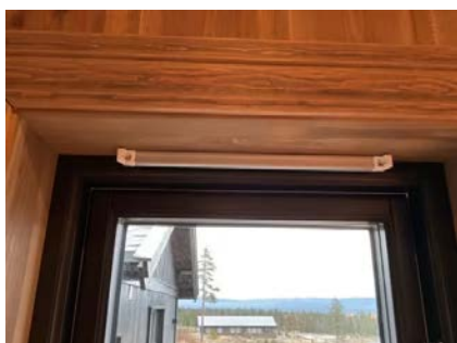
Lufteventil i vinduer.
