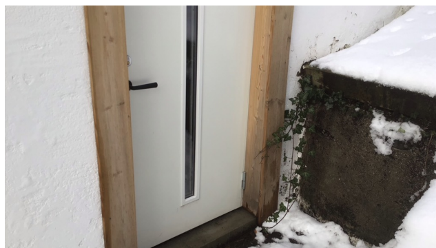
Utettheter mellom dørkarm og dørblad på kjellerdør
