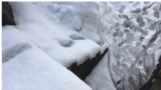
Mangler rekkverk på trapp ved kjellerdør
