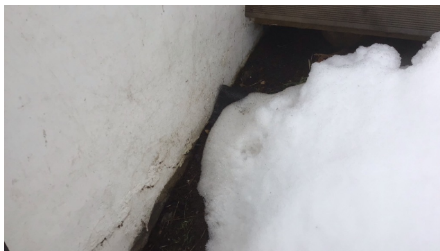
Ikke registrert fuktsikring langs grunnmur
