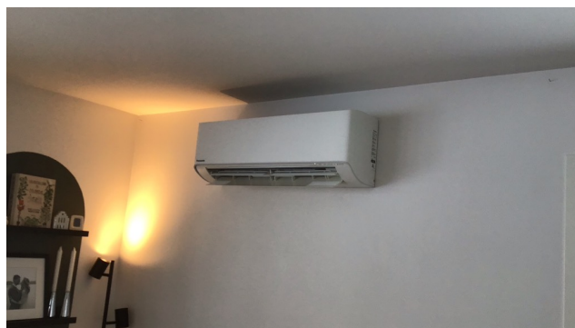
Varmepumpe i stue
