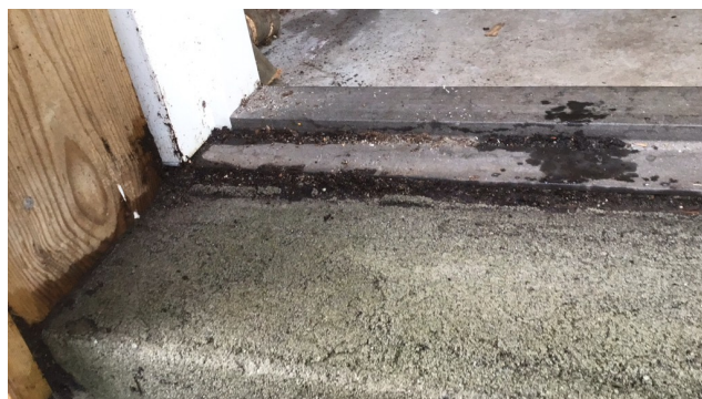
Kjellerdør med utettheter under dørsvill
