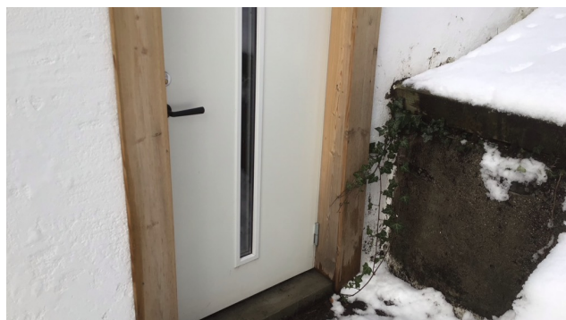
Utettheter mellom dørkarm og dørblad på kjellerdør
