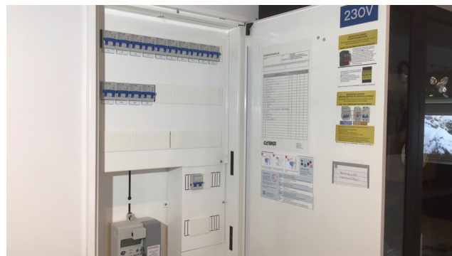
Sikringsskap i 1 etg
