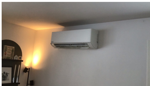
Varmepumpe i stue
