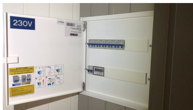
Sikringsskap i kjelleren
