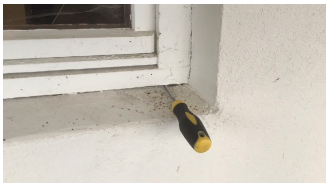
Utettheter i underkant kjellervinduer
