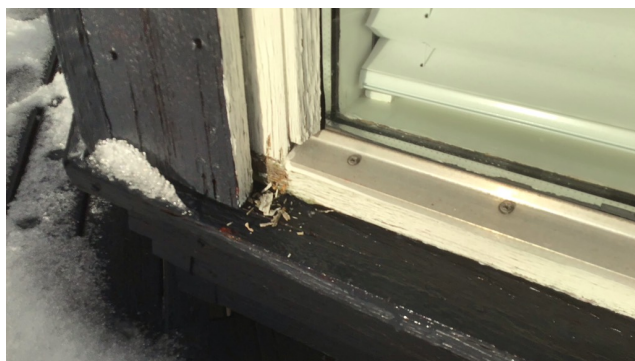
Fukt merker i stuevinduer i tilbygget
