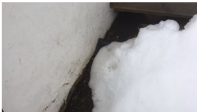
Ikke registrert fuktsikring langs grunnmur
